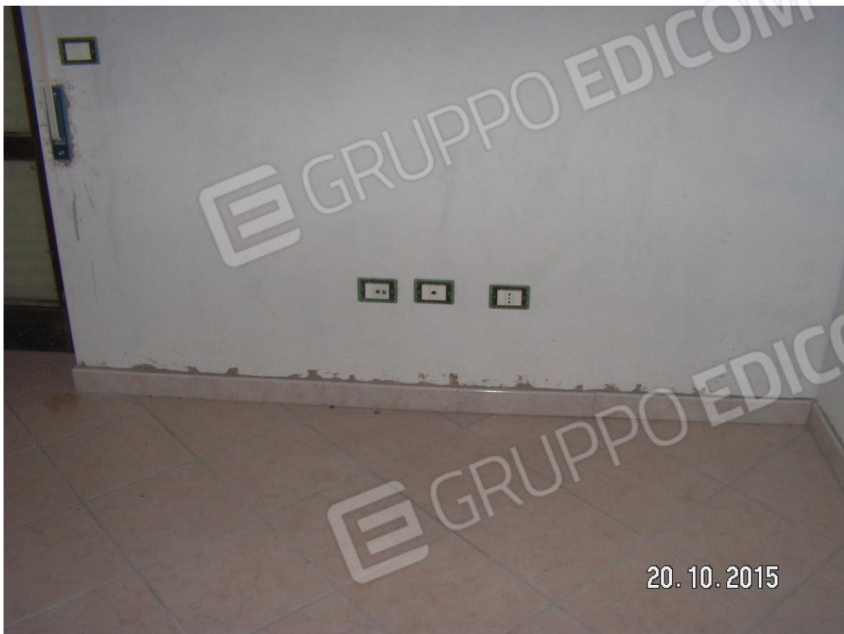
Immagine 11 – particolare interni impianti
