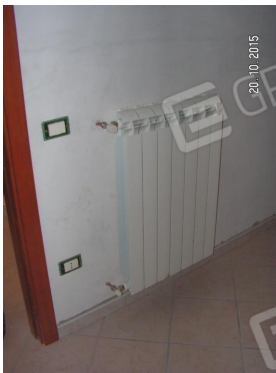
Immagine 12 – particolare interni impianti
