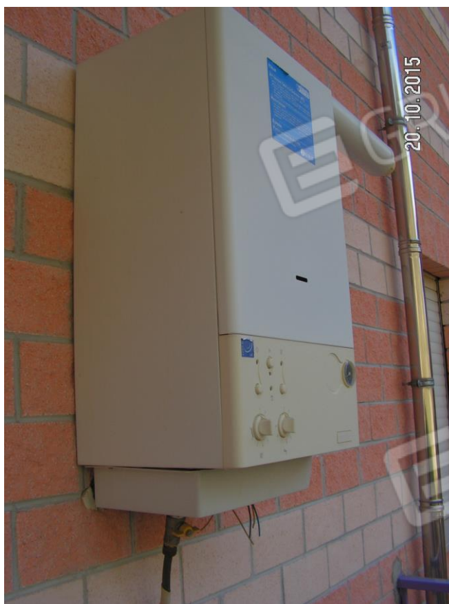
Immagine 14 – particolare interni Caldaia
