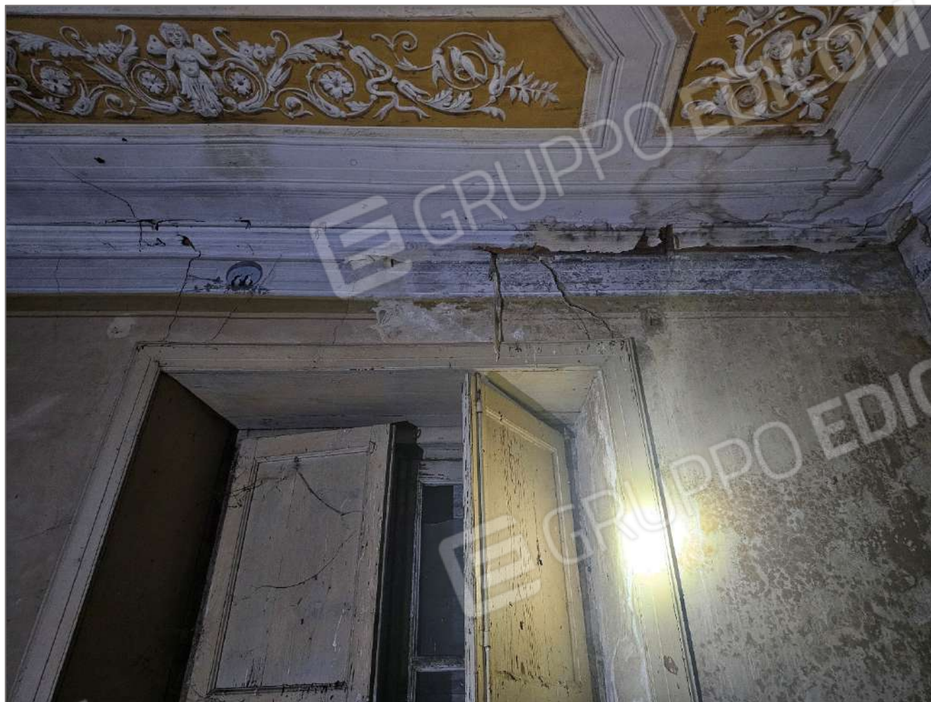
Foto 48, 49 – Quadro fessurativo all'interno del sub 25
