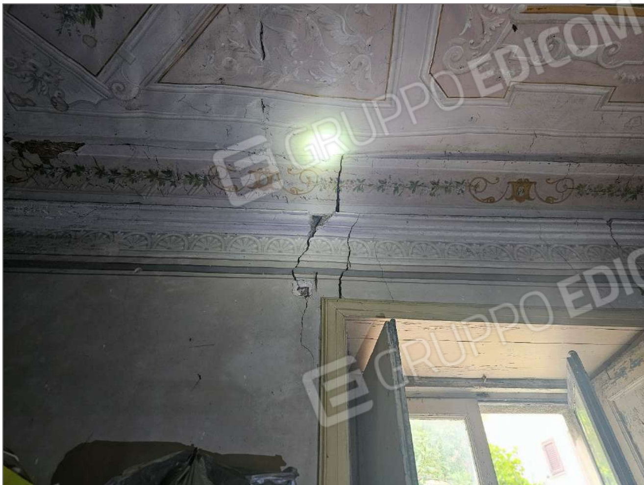
Foto 38, 39 – Quadro fessurativo all'interno del sub 25
