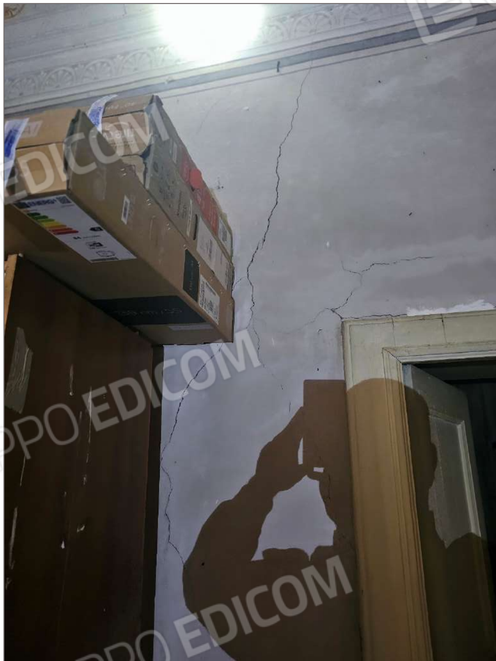
Foto 44, 45 – Quadro fessurativo all'interno del sub 25
