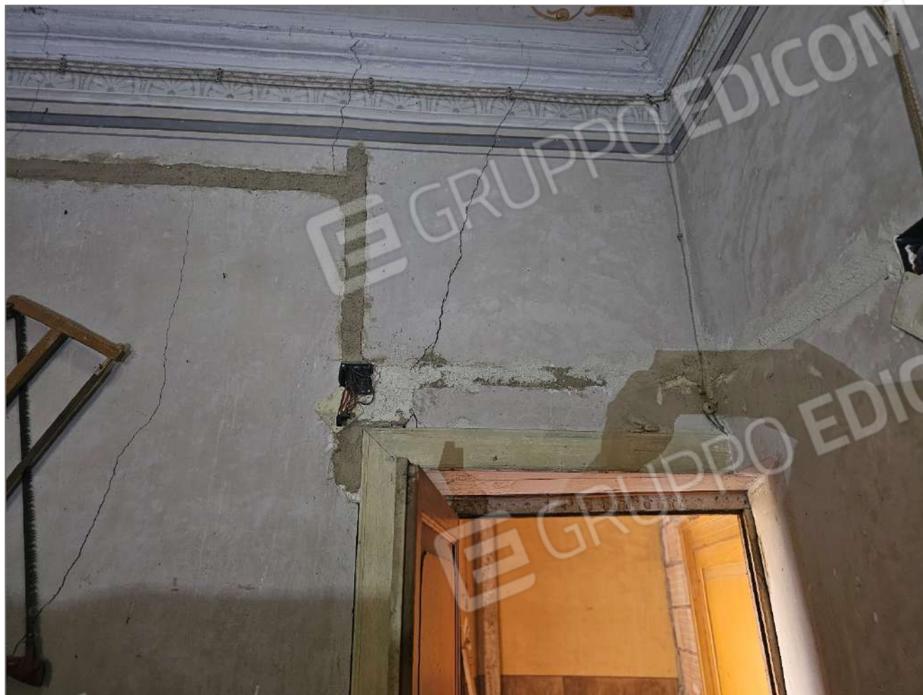
Foto 40, 41 – Quadro fessurativo all'interno del sub 25
