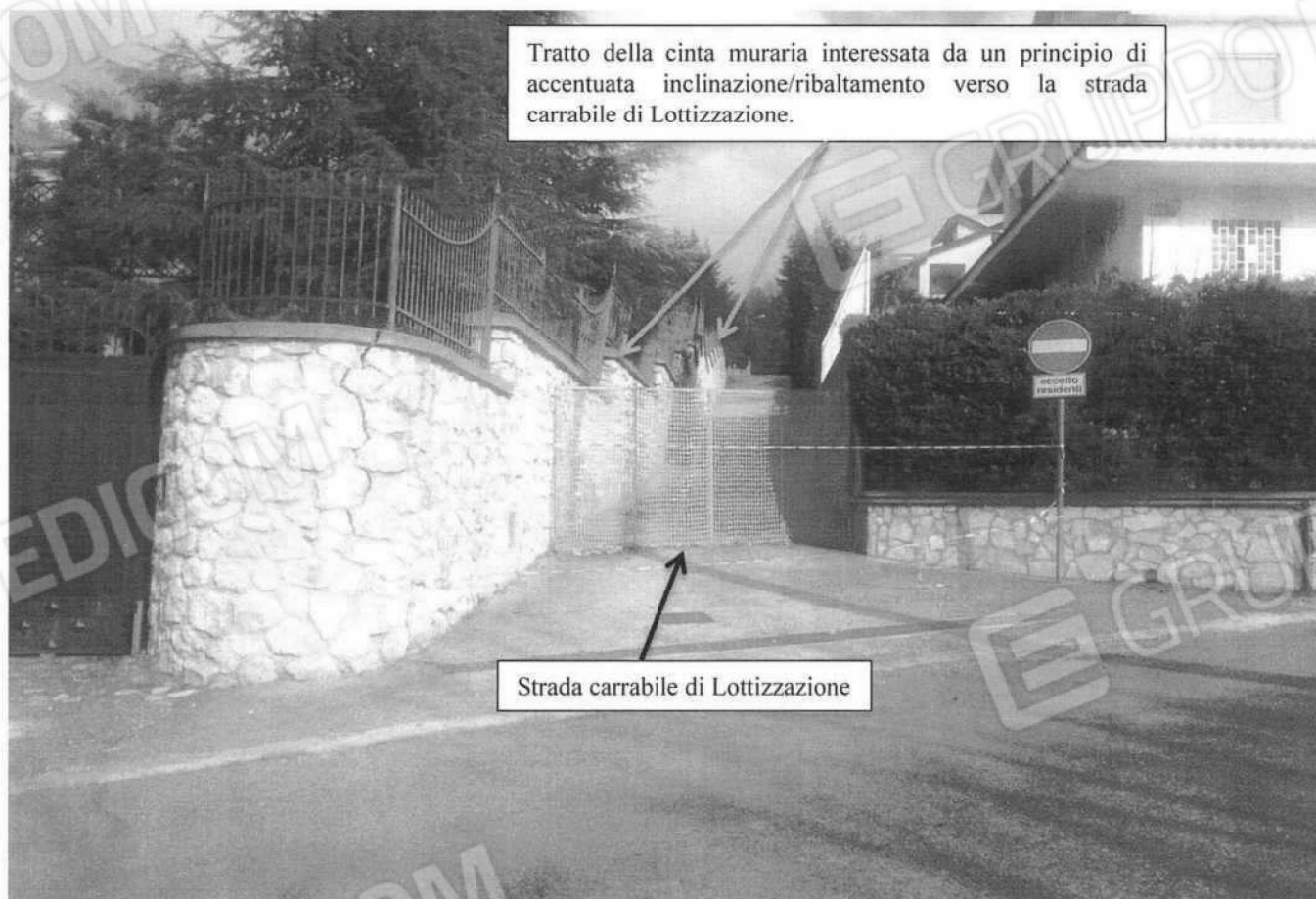
Foto 2 -Tratto della cinta muraria, del lato posto a confine della strada carrabile di Lottizzazione, interessato da un accentuato principio di inclinazione/ribaltamento verso la stessa strada.
