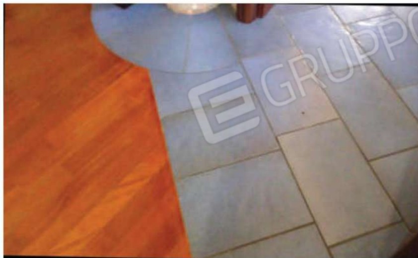
FOTO 5_Salone_ Particolare pavimento
