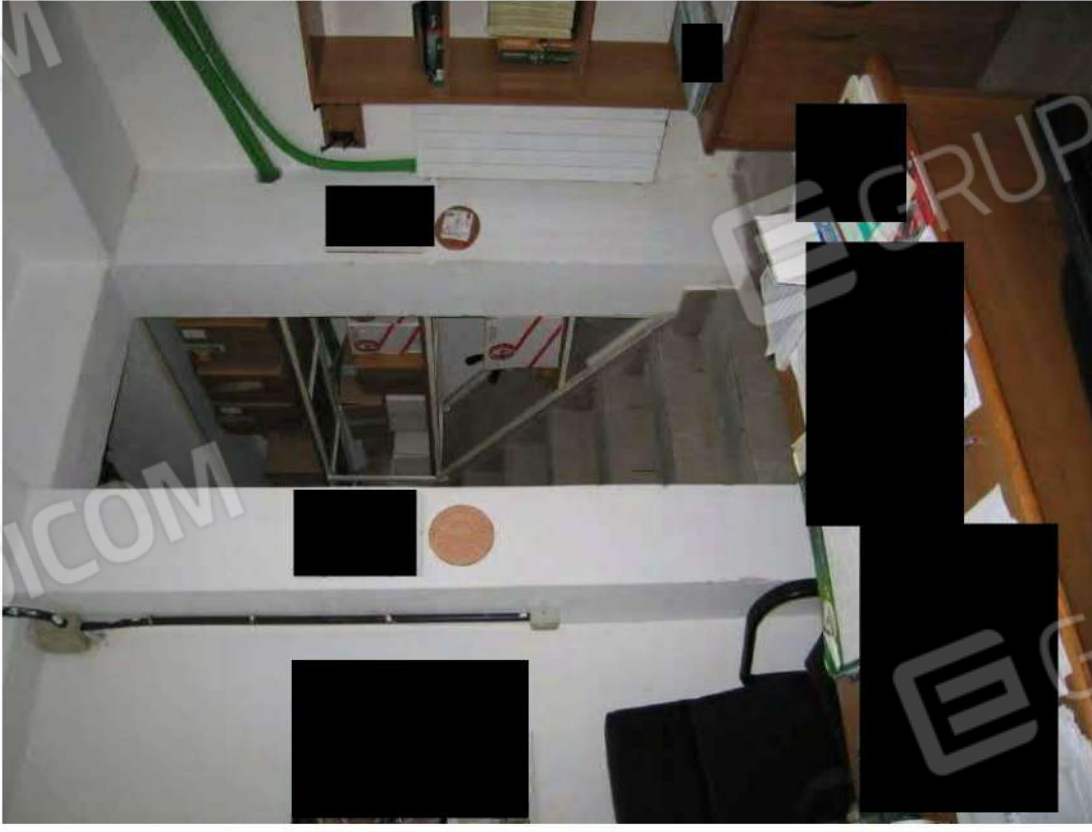
Foto n° 15 e 16 - Immobile sub 1 (piano seminterrato)
