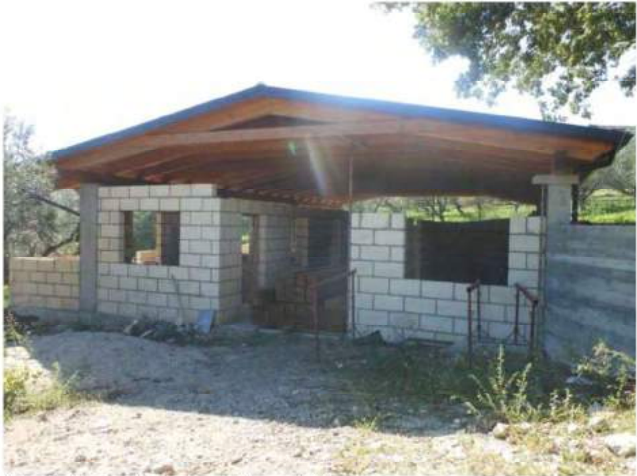
Figura 43: Fabbricato abusivo presente sulla particella 848.
