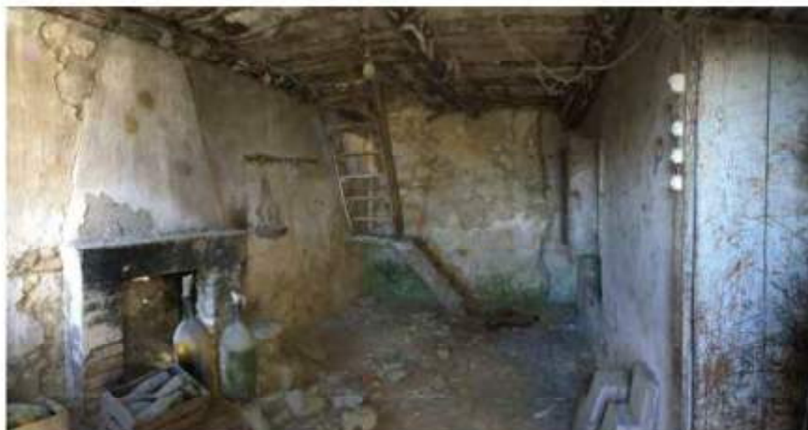
Figura 7: Unità collabente Foglio 11 particella 1397 sub 1- corpo a sud.
