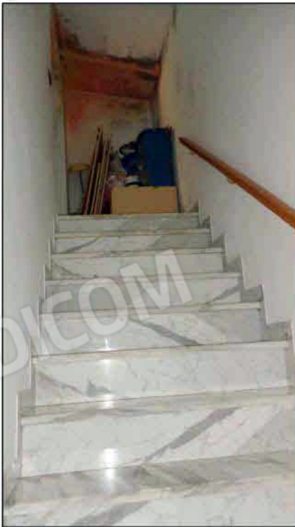
Macchie evidenti di umidità in corrispondenza dell'ultimo pianerottolo
