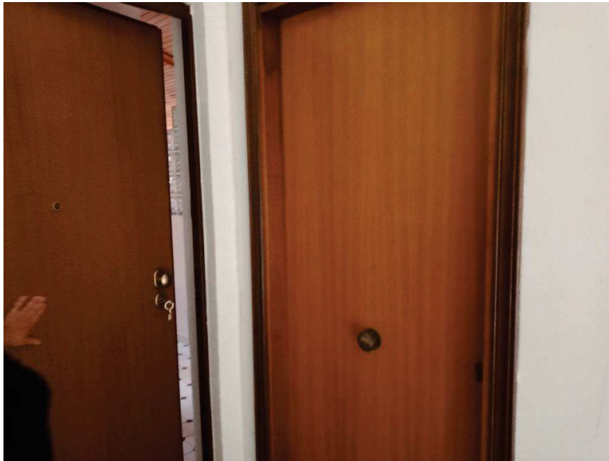
Foto 30. Sulla destra porta internamente murata locale sottotetto. A sinistra l'accesso tramite la sub 16 mansarda di proprietà degli esecutati.
