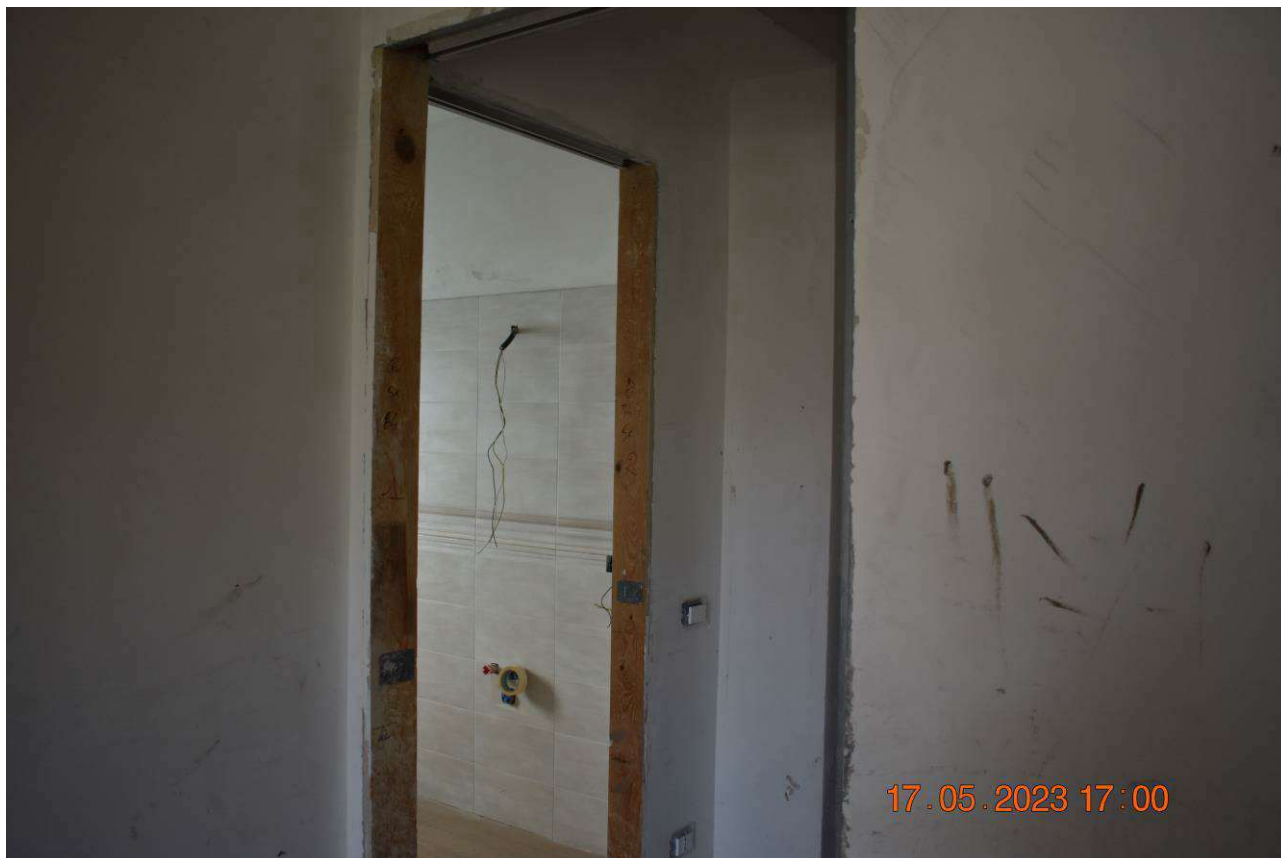
FOTO N.11: Disimpegno con vista parziale del bagno. Si nota l'assenza delle porte interne.
