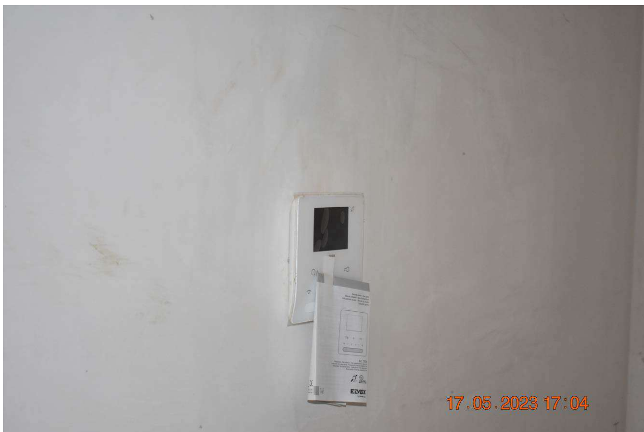
FOTO N.5: Ingresso soggiorno, particolare termostato
