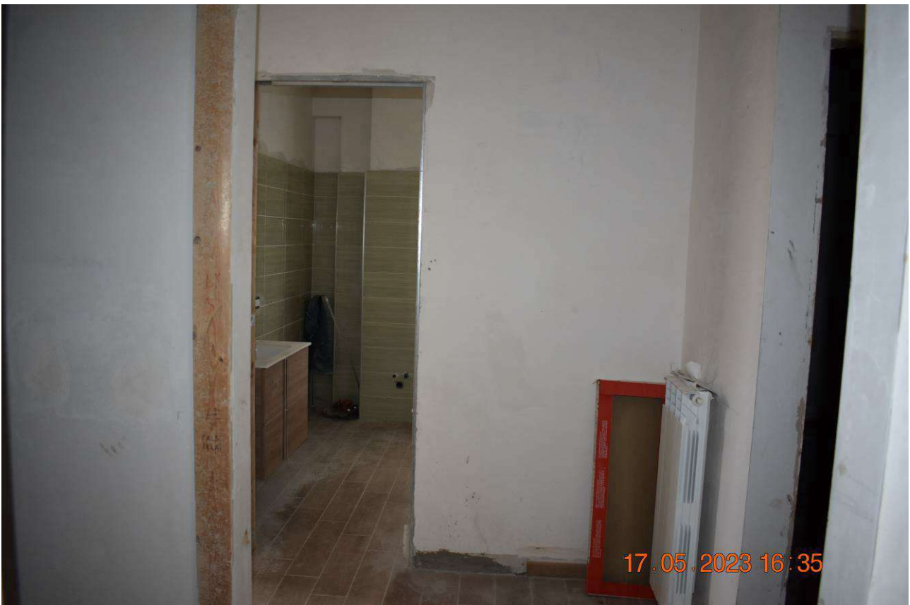
FOTO N.18: Disimpegno, con accesso al bagno ed alle due camere da letto. Si nota l'assenza delle porte interne.
