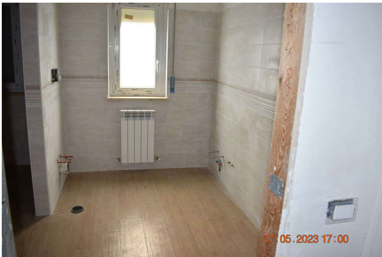
FOTO N.12: Bagno. Si nota l'assenza delle porte interne e dei pezzi igienici.
