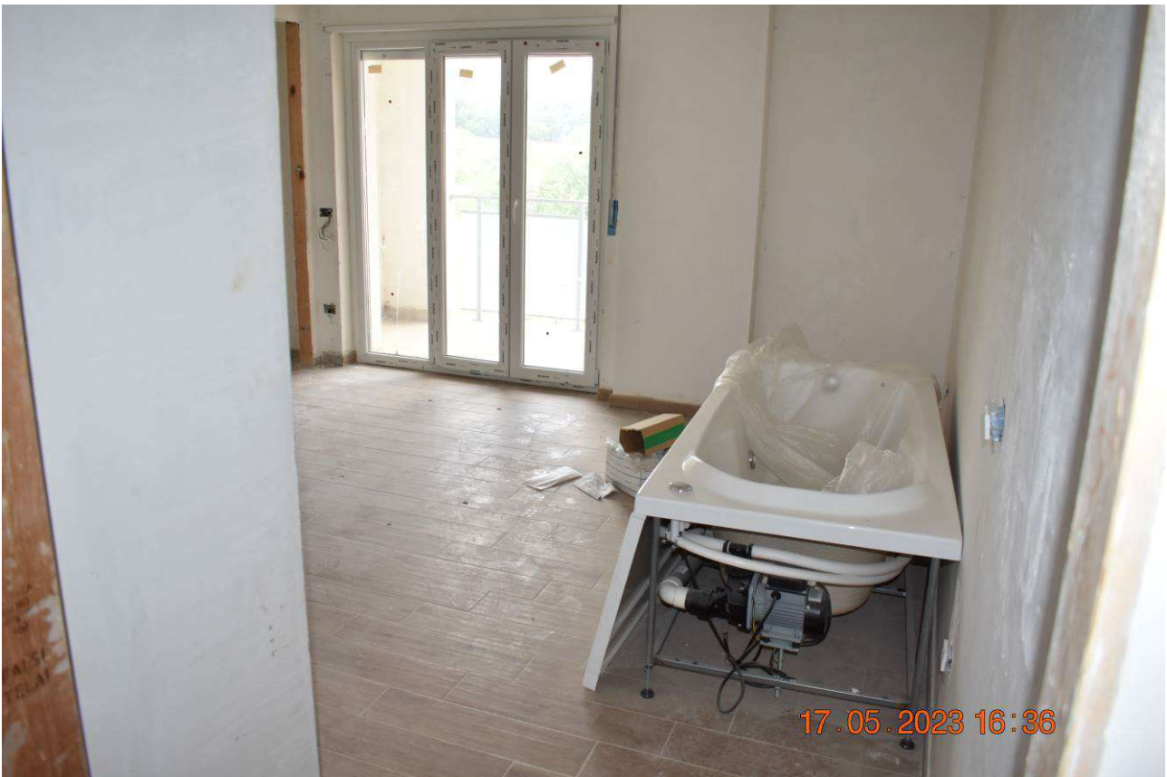
FOTO N.26: Camera da letto 1. Vasca da bagno depositata in questo vano.
