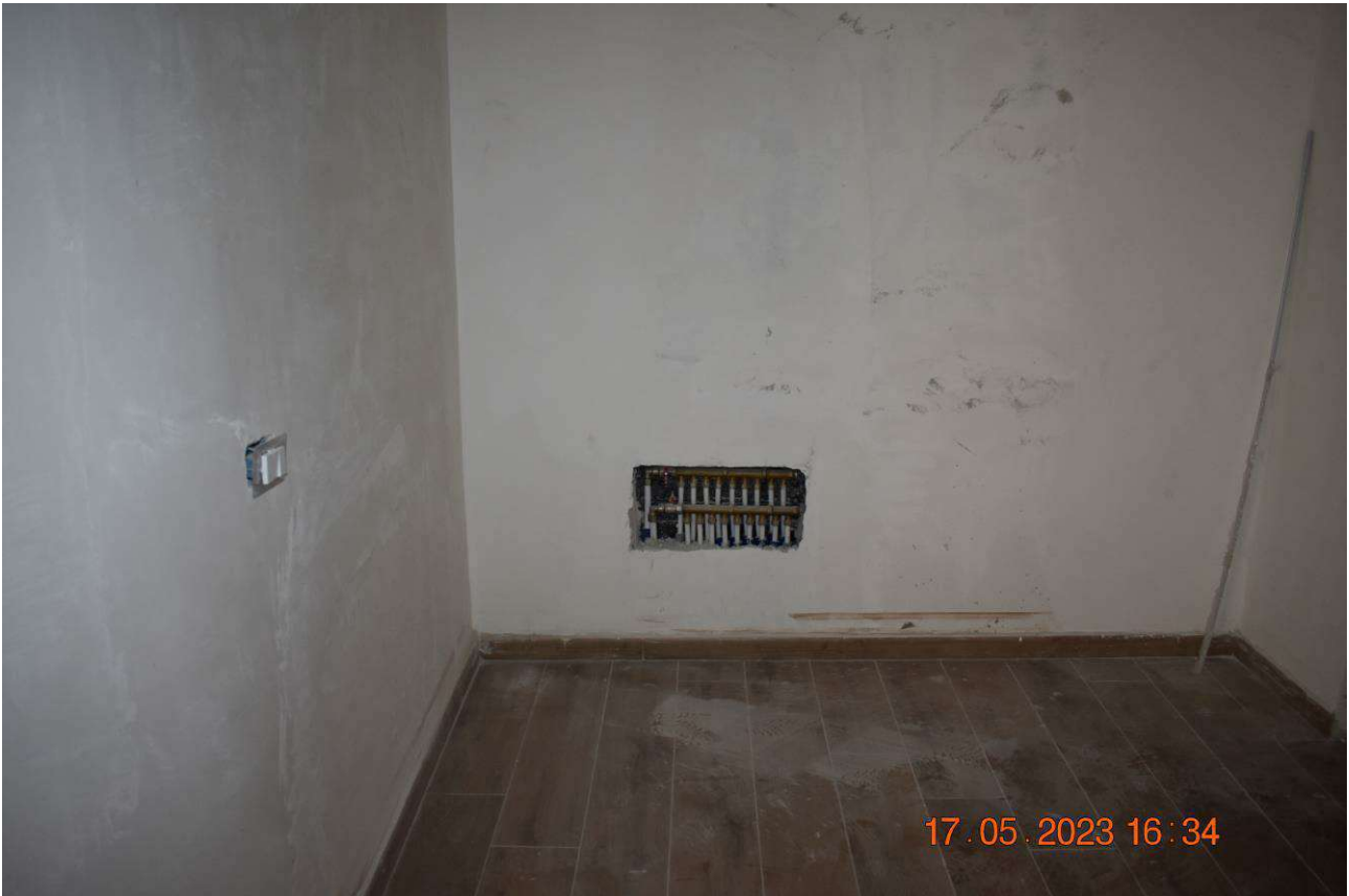
FOTO N.17: Ingresso soggiorno, in questo vano si notano i collettori dell'impianto di riscaldamento e gli interruttori senza coperchi.
