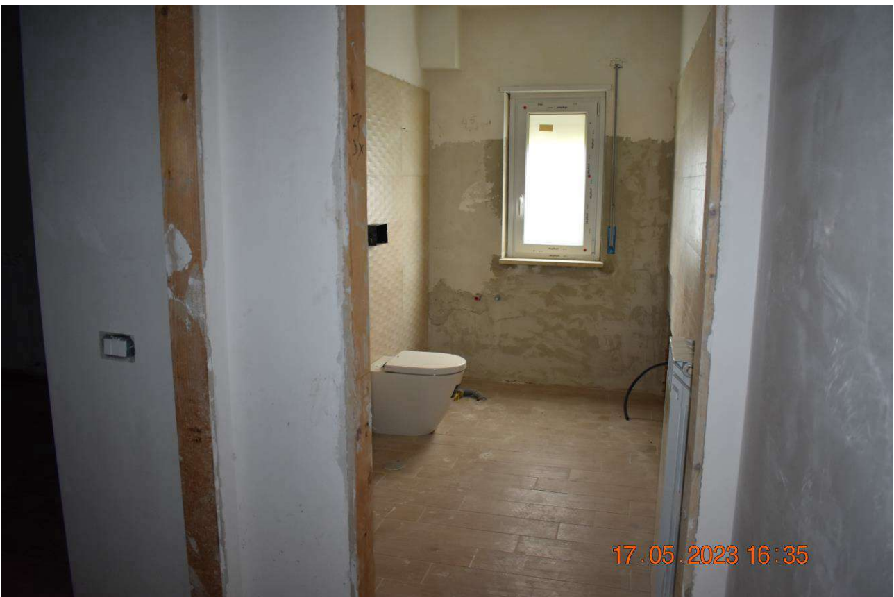
FOTO N.20: Bagno n.1 Privo di rivestimento e degli altri pezzi igienici oltre al vaso.
