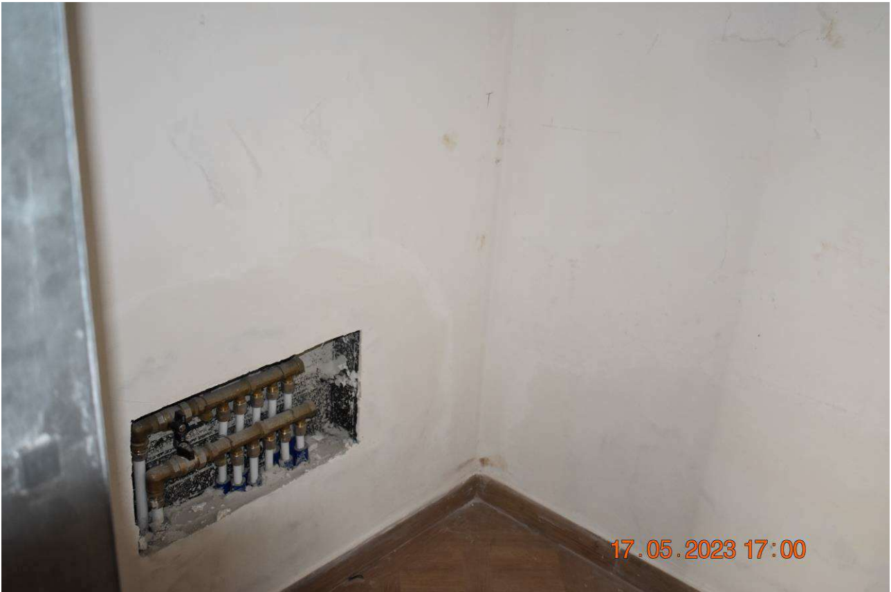
FOTO N.17: Particolare collettori riscaldamento.
