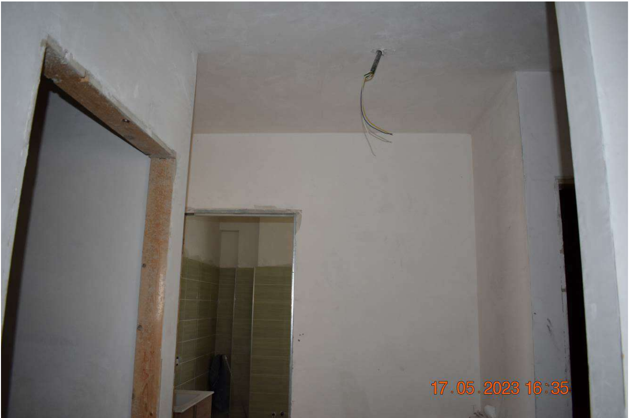
FOTO N.19: Disimpegno. Impianto elettrico sul soffitto. Mancano le porte interne
