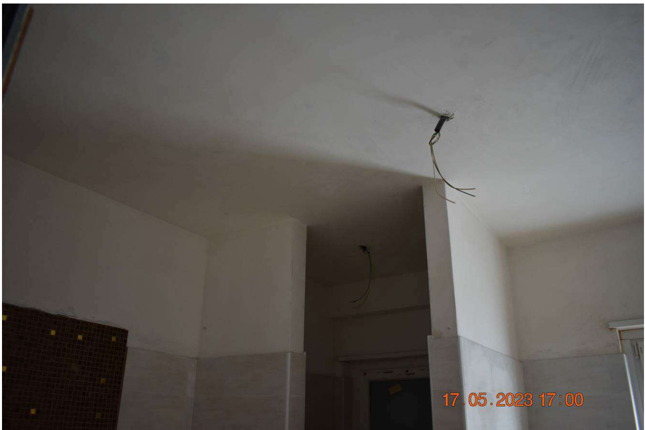
FOTO N.14: Bagno. Si nota l'esistenza dei cavi elettrici
