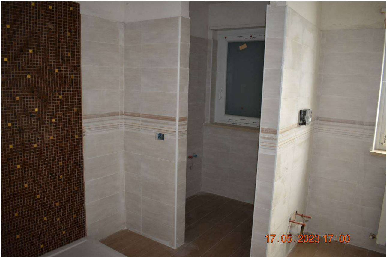
FOTO N.13: Bagno. Si nota l'assenza dei pezzi igienici.
