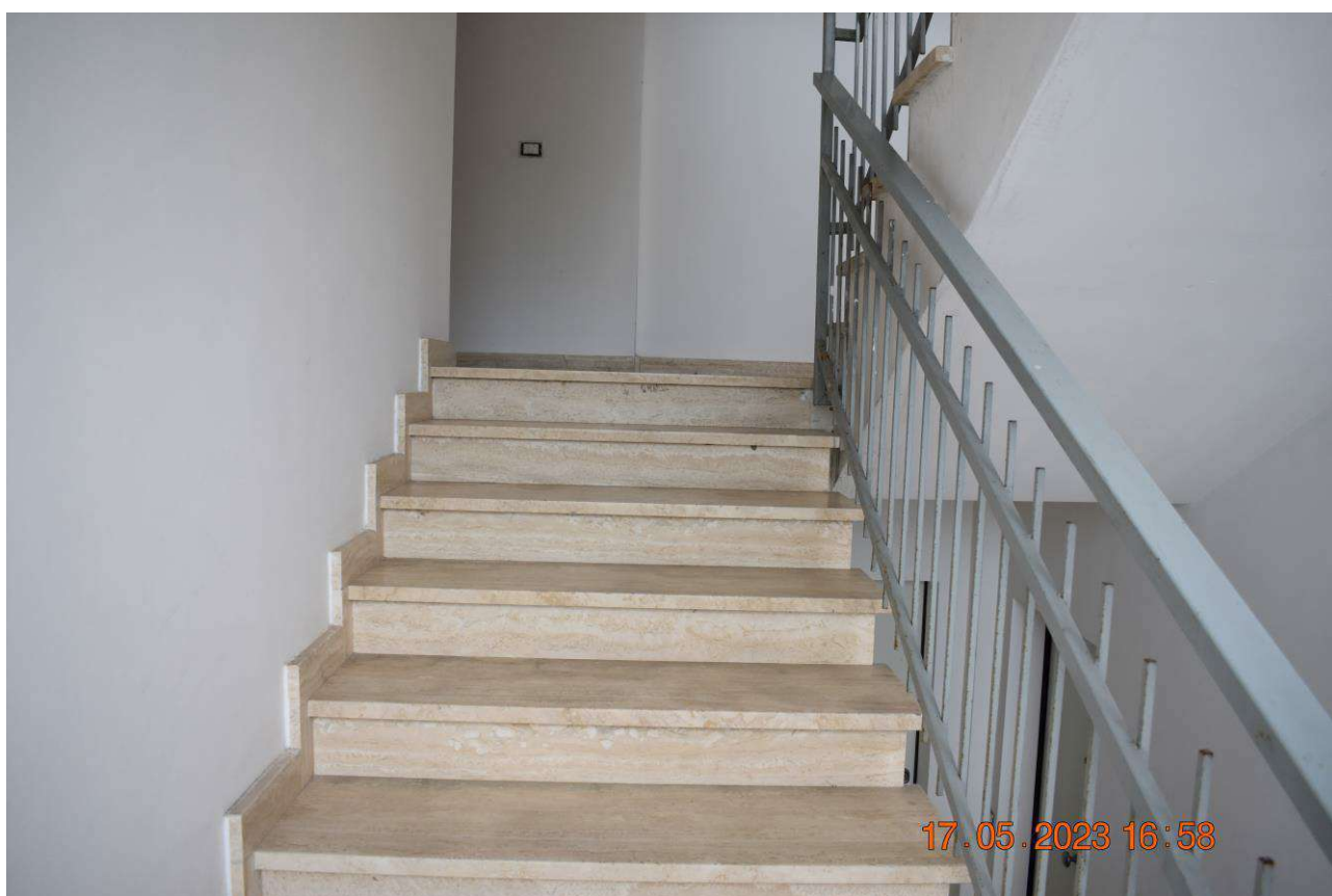
FOTO N.2: Seconda rampa di scala dal primo piano (sub 5) al secondo piano (sub 6).
