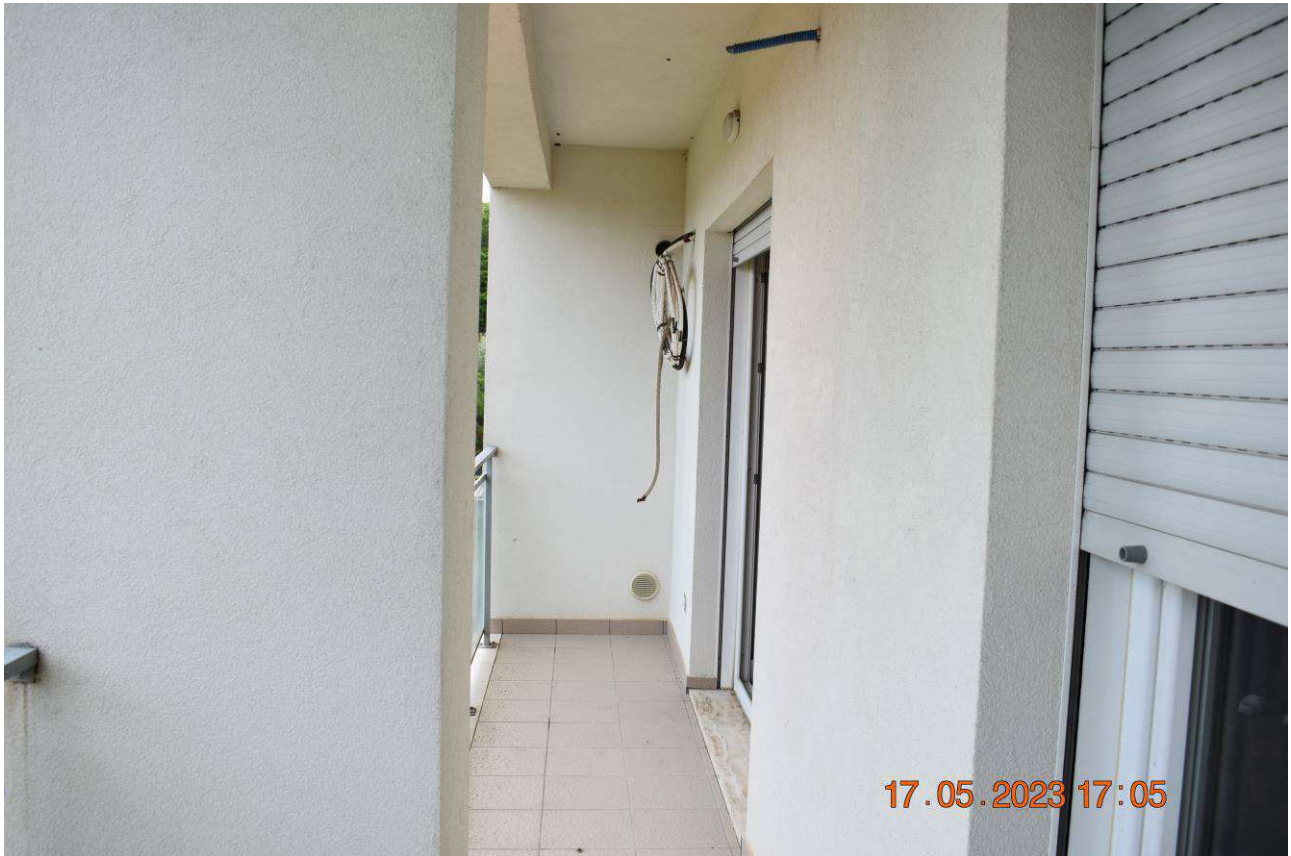
FOTO N.35: Terrazzo lato sud. In fondo si vedono i cavi per collegare la caldaia
