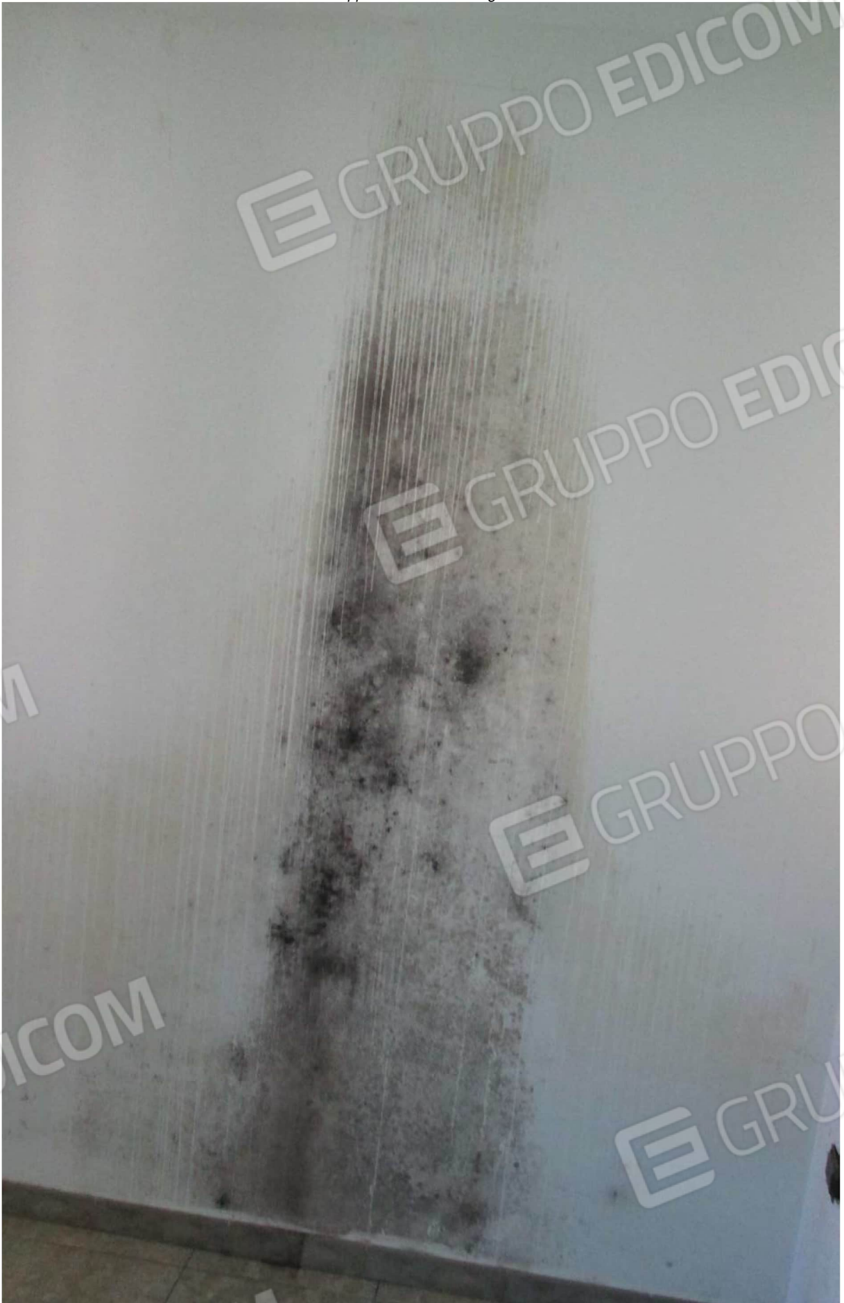
Uno dei due ponti termici da correggere
