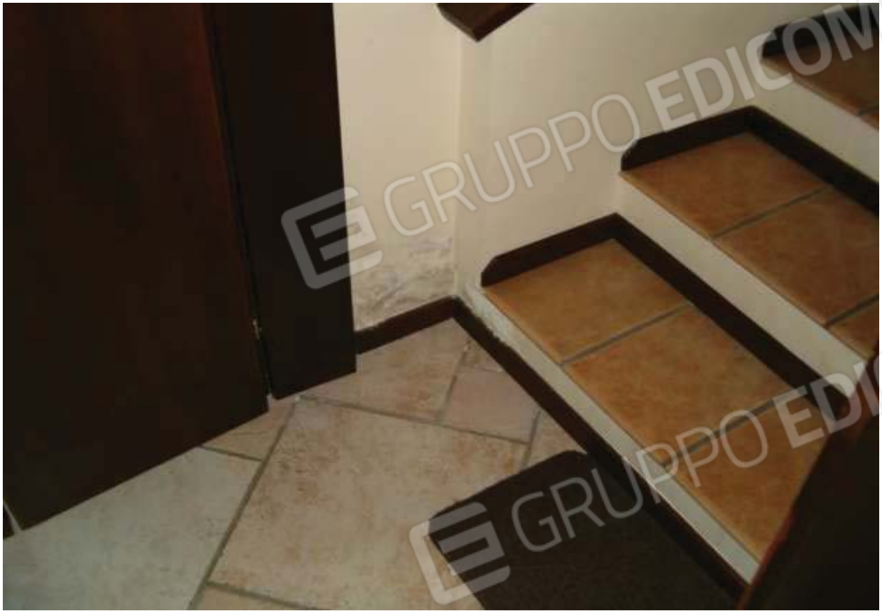
Foto n°17 –Vano scala al piano sottostrada, Tracce di Umido
