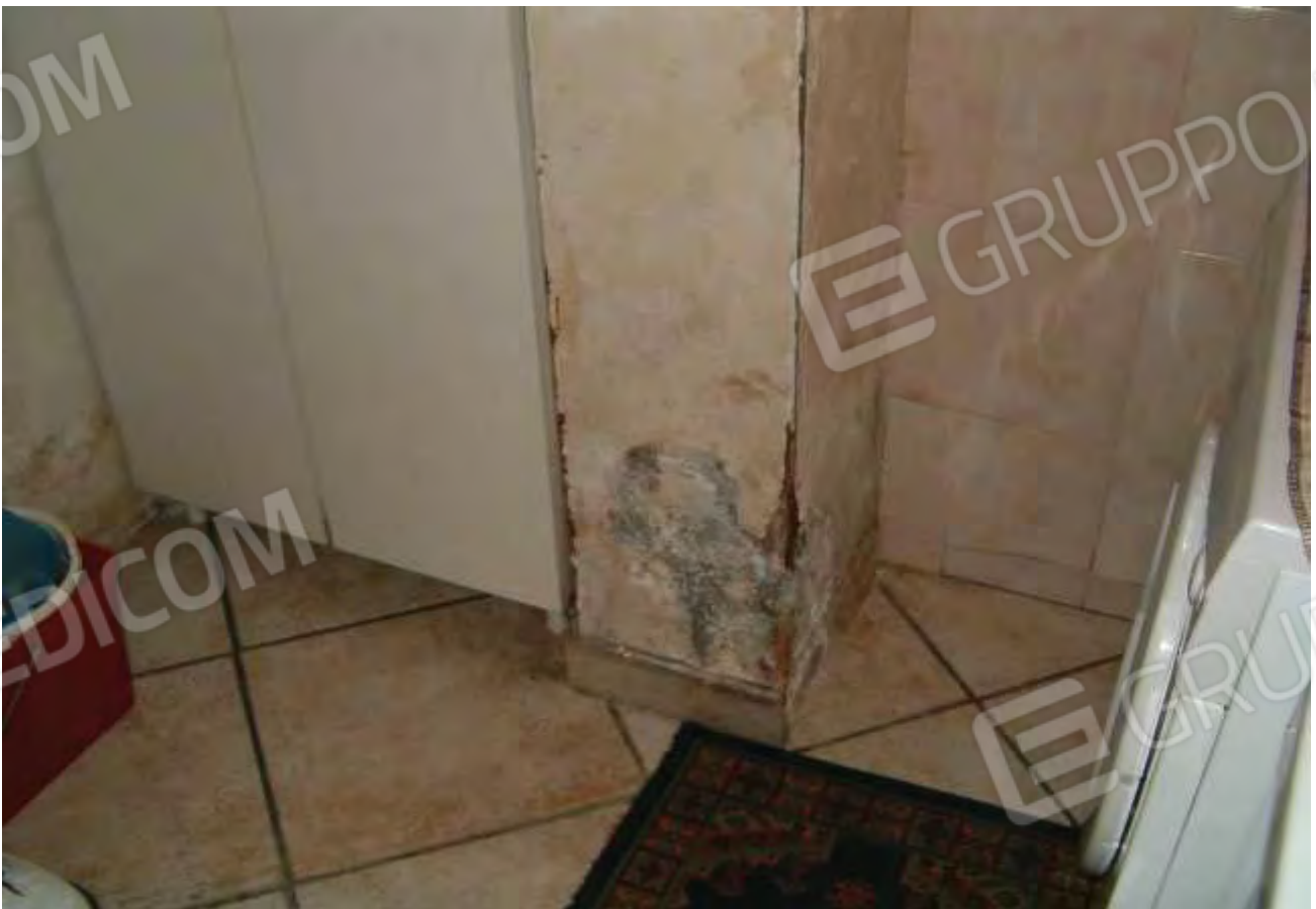
Foto n°14 –Locale da bagno al piano sottostrada, particolare tracce di umido
