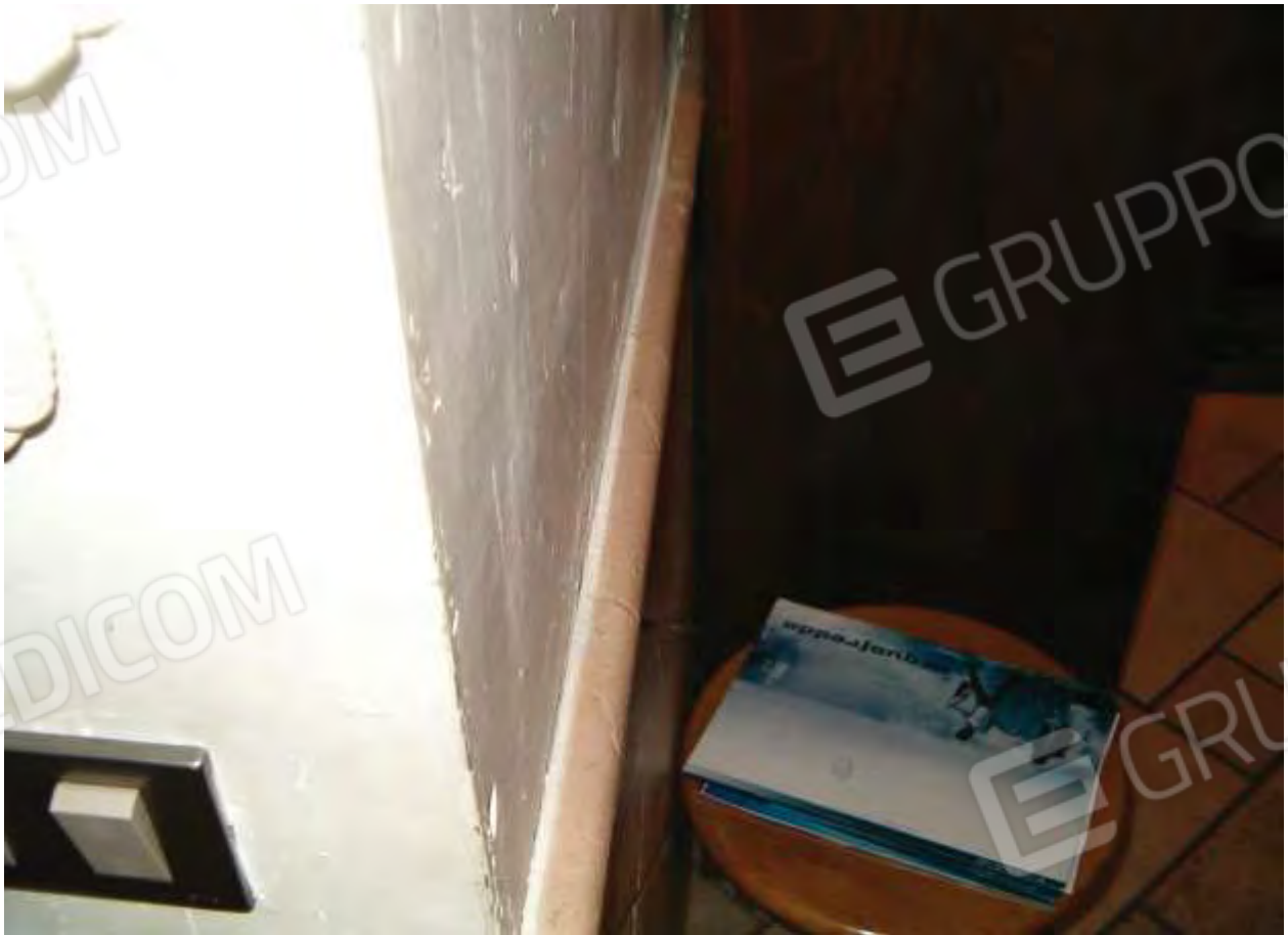
Foto n°16 –Locale Cucina Soggiorno al piano sottostrada, particolare tracce di umido
