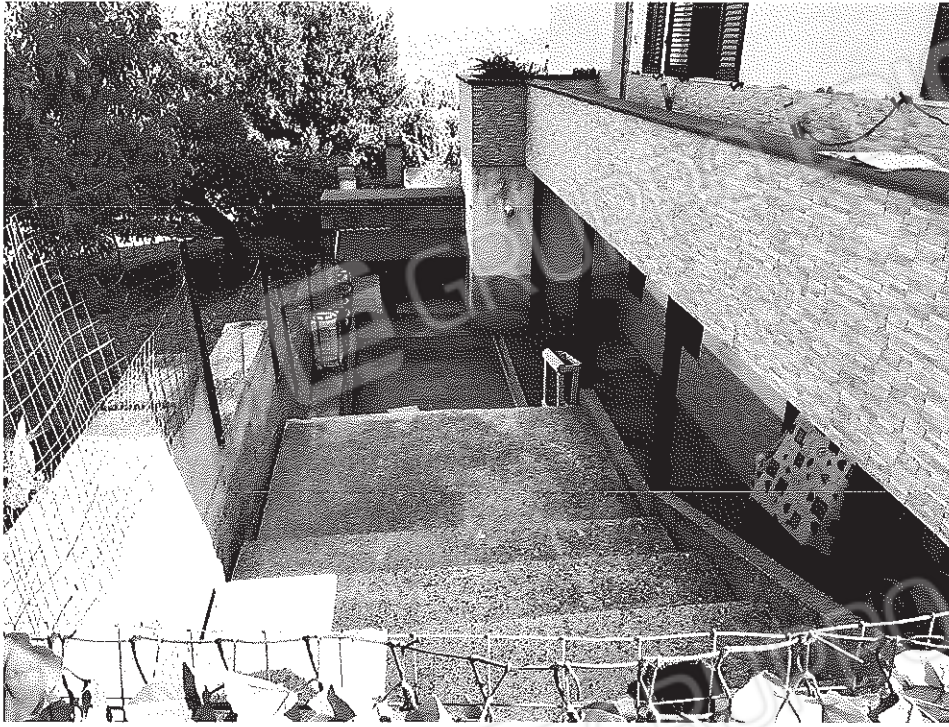
Scala in c.a. (opera abusiva) vista da sopra (porzione corte lato Via Turano).
