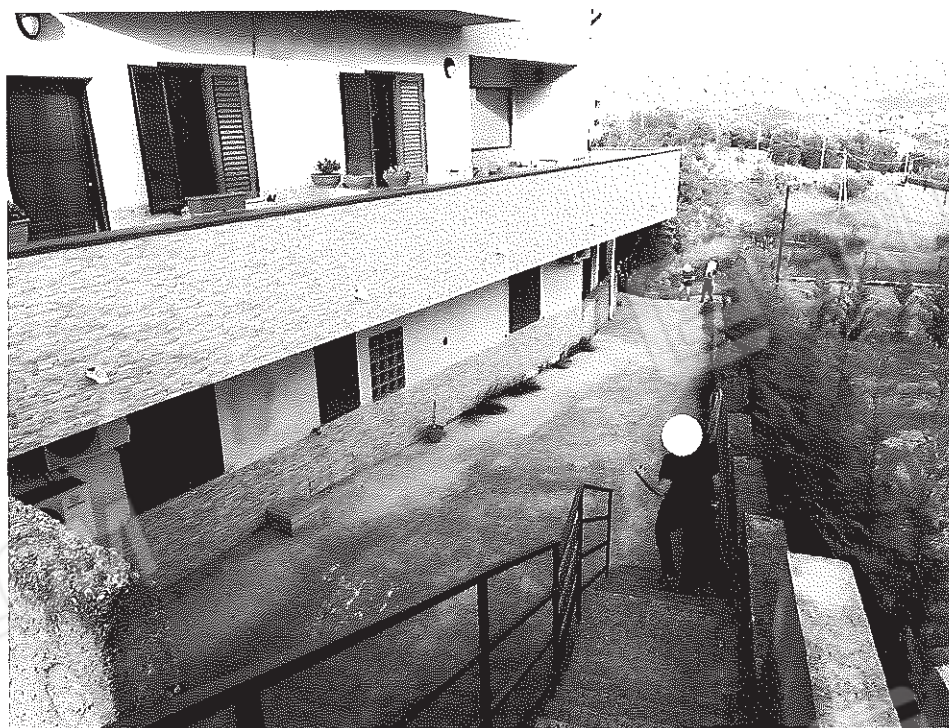
Scala in c.a. (opera abusiva) vista da sopra (Via Turano).
