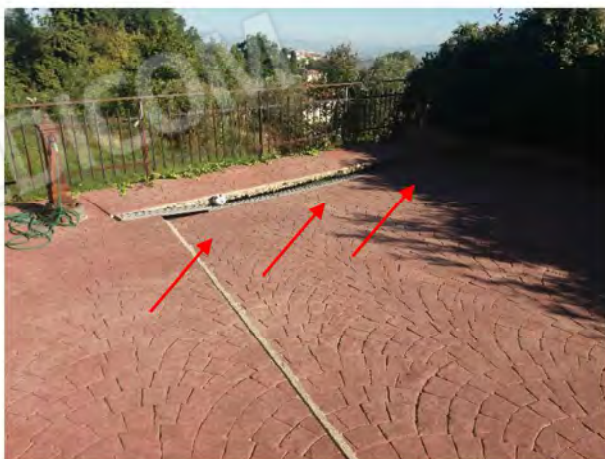
Foto 9: Corte privata lato Nord. Particolare lesioni pavimentazione
