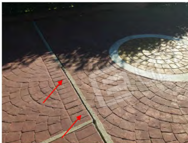
Foto 10: Corte privata zona centrale. Particolare lesioni pavimentazione
