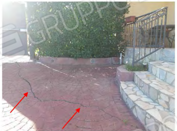
Foto 14: Particolare lesioni alla corte nei pressi della zona d'ingresso alla corte
