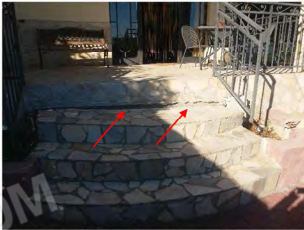
Foto 13: Gradini per l'accesso al piano seminterrato. Lesioni ai gradini
