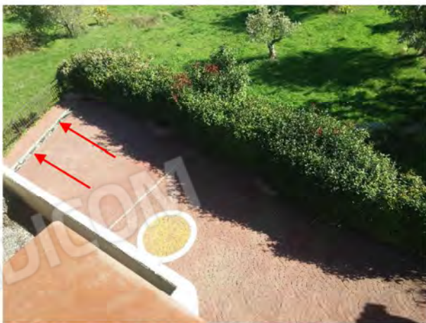
Foto 15: Vista dall'alto della corte zona Nord. Lesioni evidenti e distacco nei pressi della griglia di raccolta acque meteoriche
