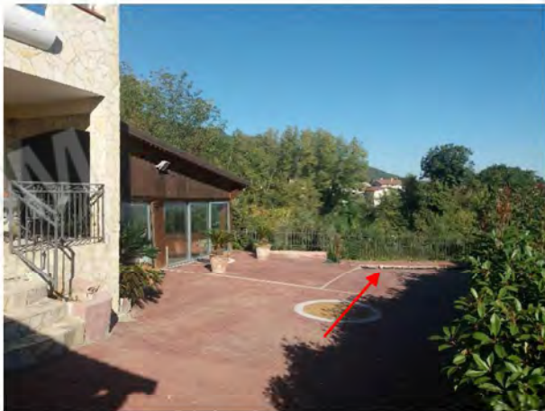
Foto 7: Corte privata lato Est. Si notino lesioni pavimentazione
