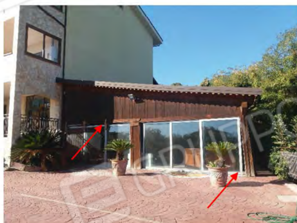
Foto 8: Struttura in legno lamellare realizzata sul lato Nord. Si notino lesioni alla struttura
