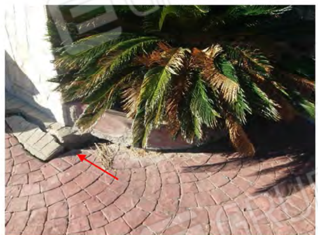
Foto 16: Spigolo Nord-Est fabbricato. Lesioni pavimentazione
