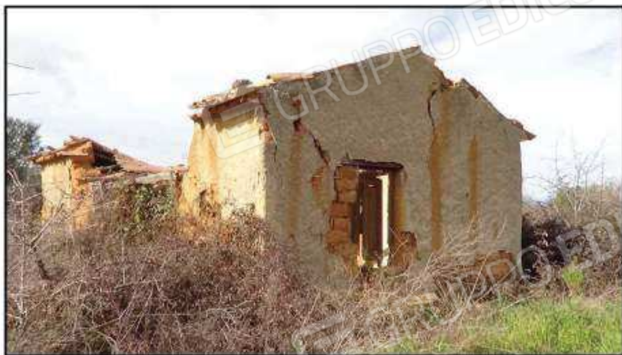
Foto n. 5 : Terreno in loc. "Serafinello", Fg 2 P.Ila 171 (ciò che resta del vecchio fabbricato rurale)
