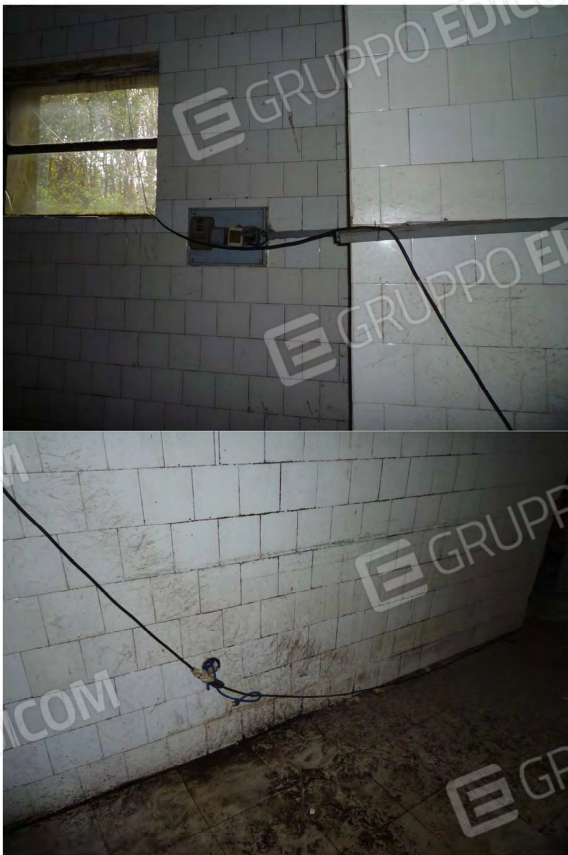
FOTO 30-31 fili elettrici aerei sala lavorazione 3
