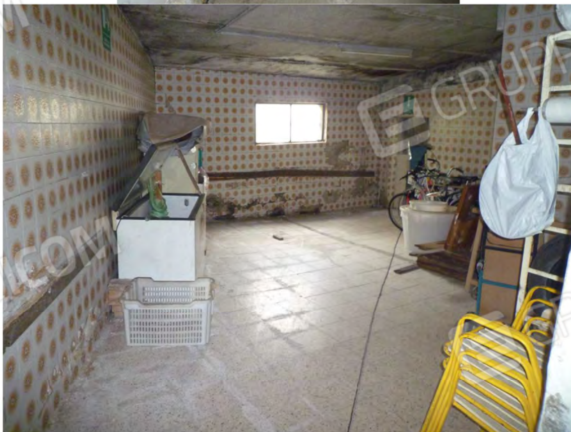
FOTO 32-33 deposito traccia di filo elettrico sul pavimento
