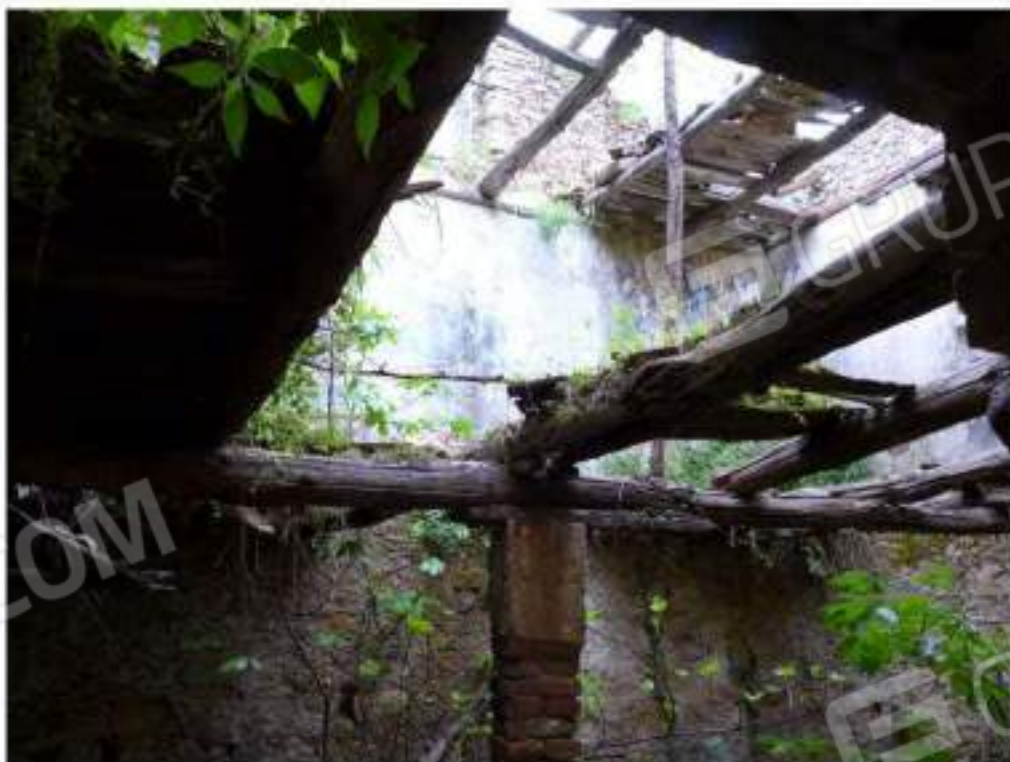
Foto n. 10: fabbricato privo di copertura e del solai di interpiano
