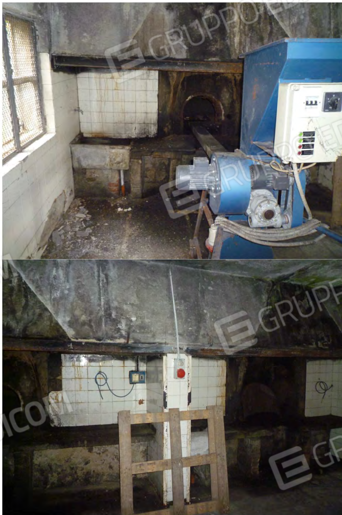
FOTO 38-39 forni a legna sala lavorazione 4
