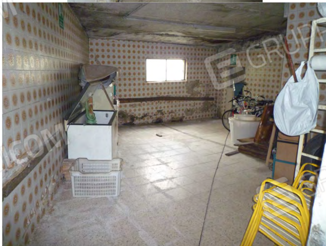
FOTO 32-33 deposito traccia di filo elettrico sul pavimento
