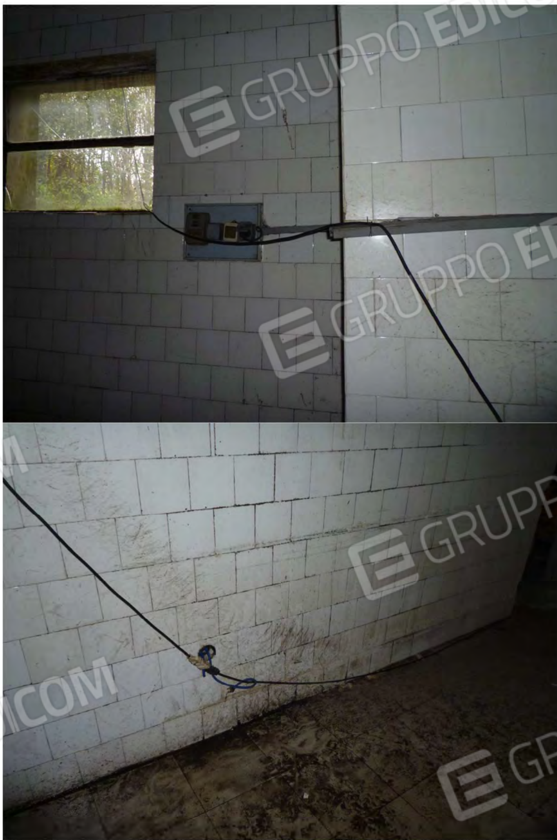
FOTO 30-31 fili elettrici aerei sala lavorazione 3
