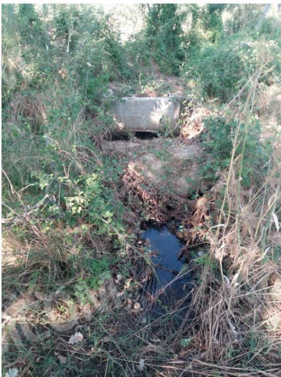
Foto n. 13 – Canale di scolo
