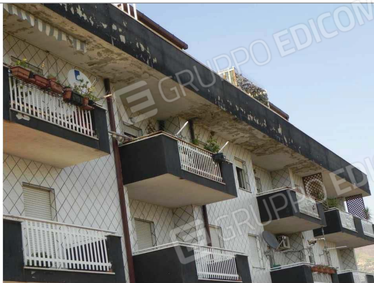
Foto n.3: prospetto lato SUD – particolare succioli deteriorati
