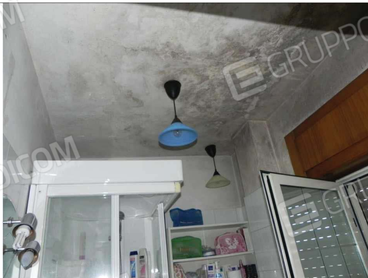
Foto n.24: succielo del bagno in camera deteriorato
