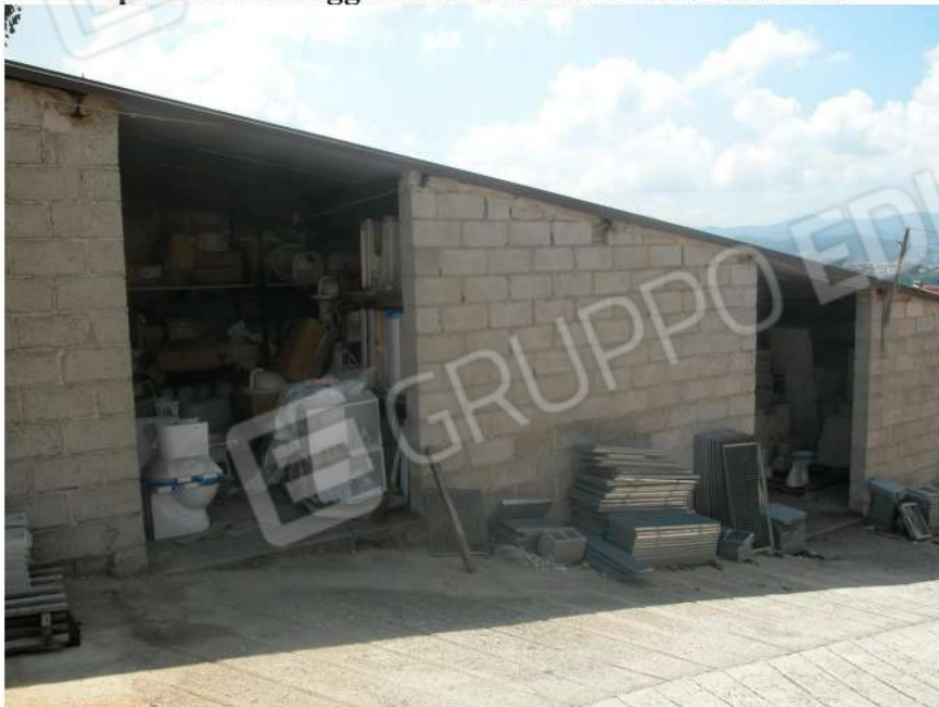
Foto 43 - esterno p.lla p.lla 1568 opera edilizia aggiuntiva abusiva e non accatastata
