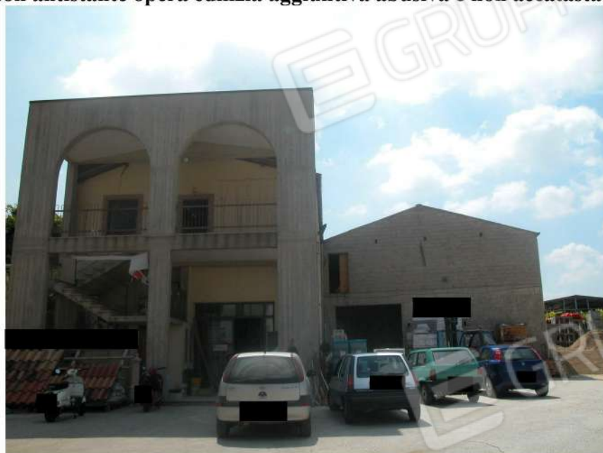
Foto 2 - esterno p.lla 1569 Sub1 e Sub2 con antistante opera edilizia aggiuntiva abusiva e non accatastata
