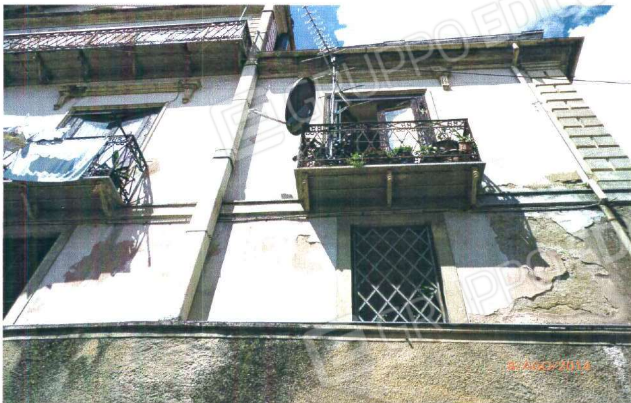
UMIDITA' SULLA FACCIATA OVEST
