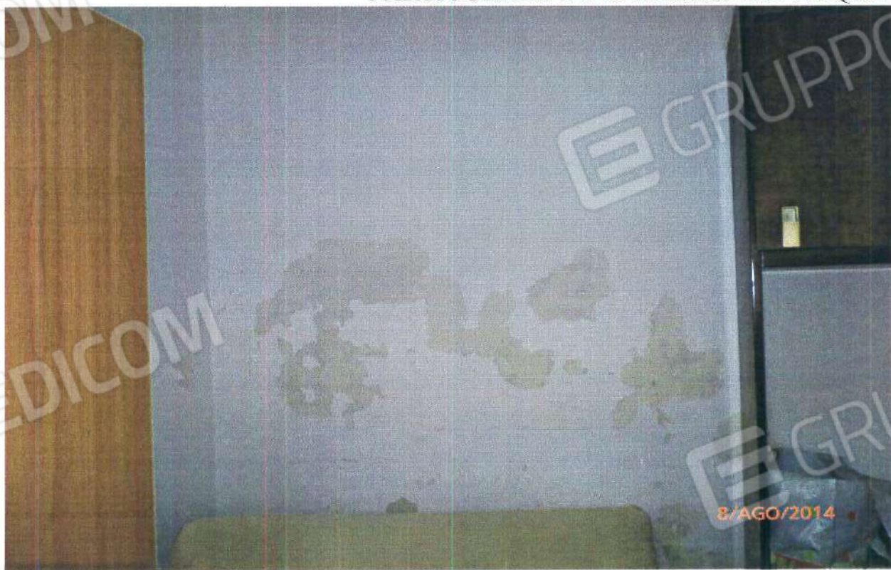
PARTICOLARE INFILTRAZIONE D'ACQUA
