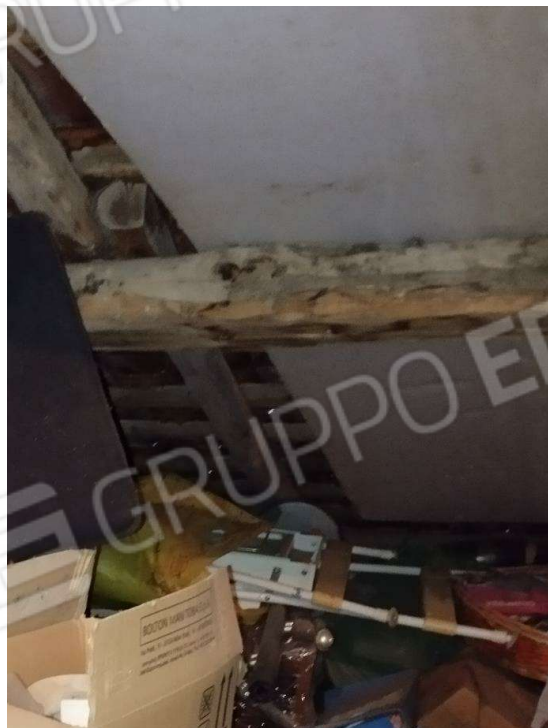
Dettagli – travi copertura ammalorate
