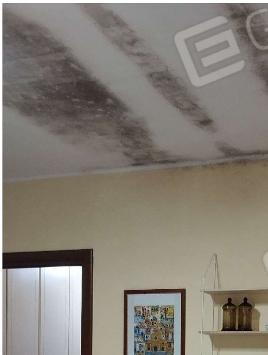
Dettagli – umidità cucina
