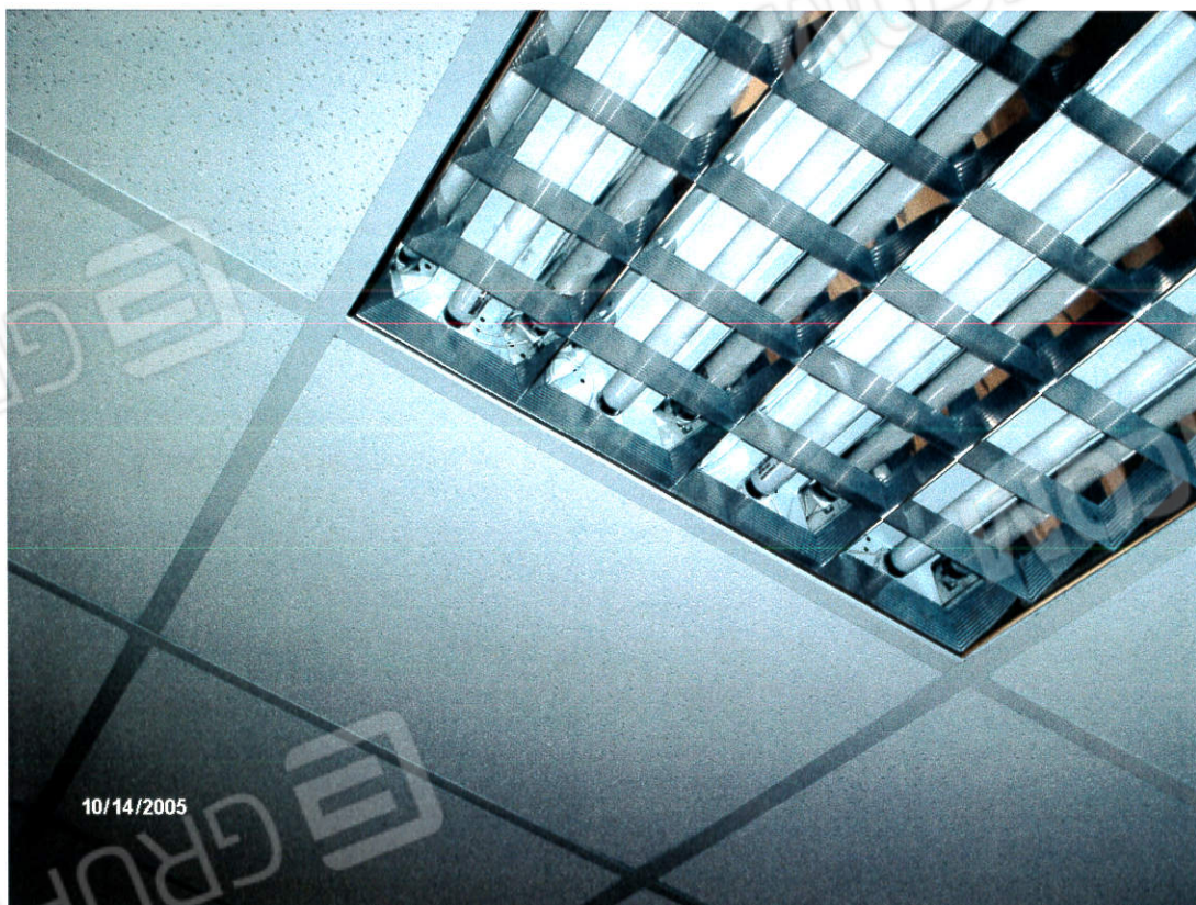
Foglio 39 p.lla 165 sub 7 soffitto
