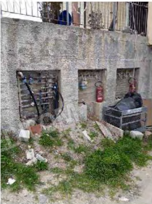
Foto n.3 Contatori acque ed gas all'ingresso dei garages
