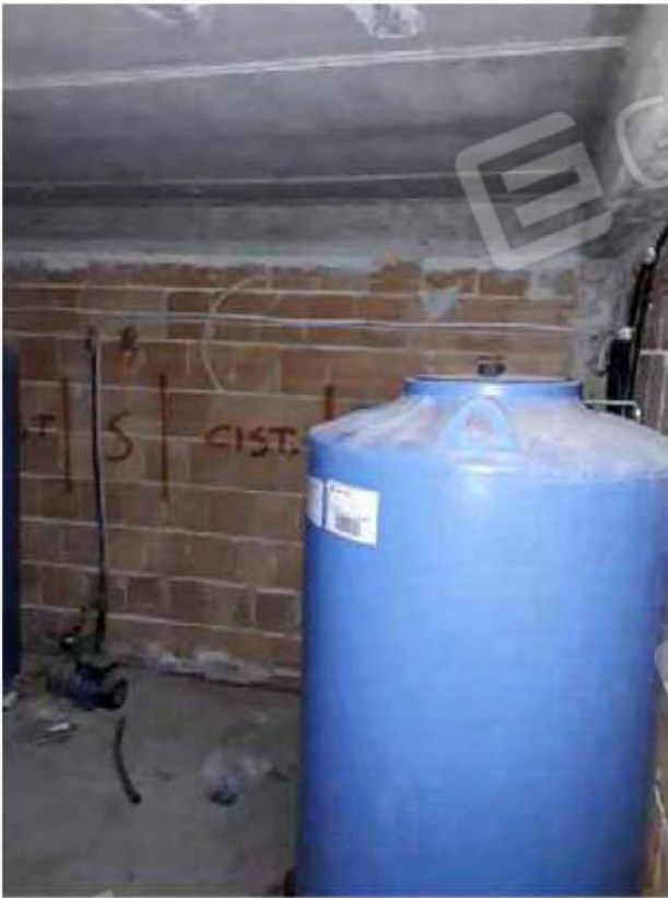
Foto n.1 locale tecnico foglio n 50 p.lla 466 sub 16
