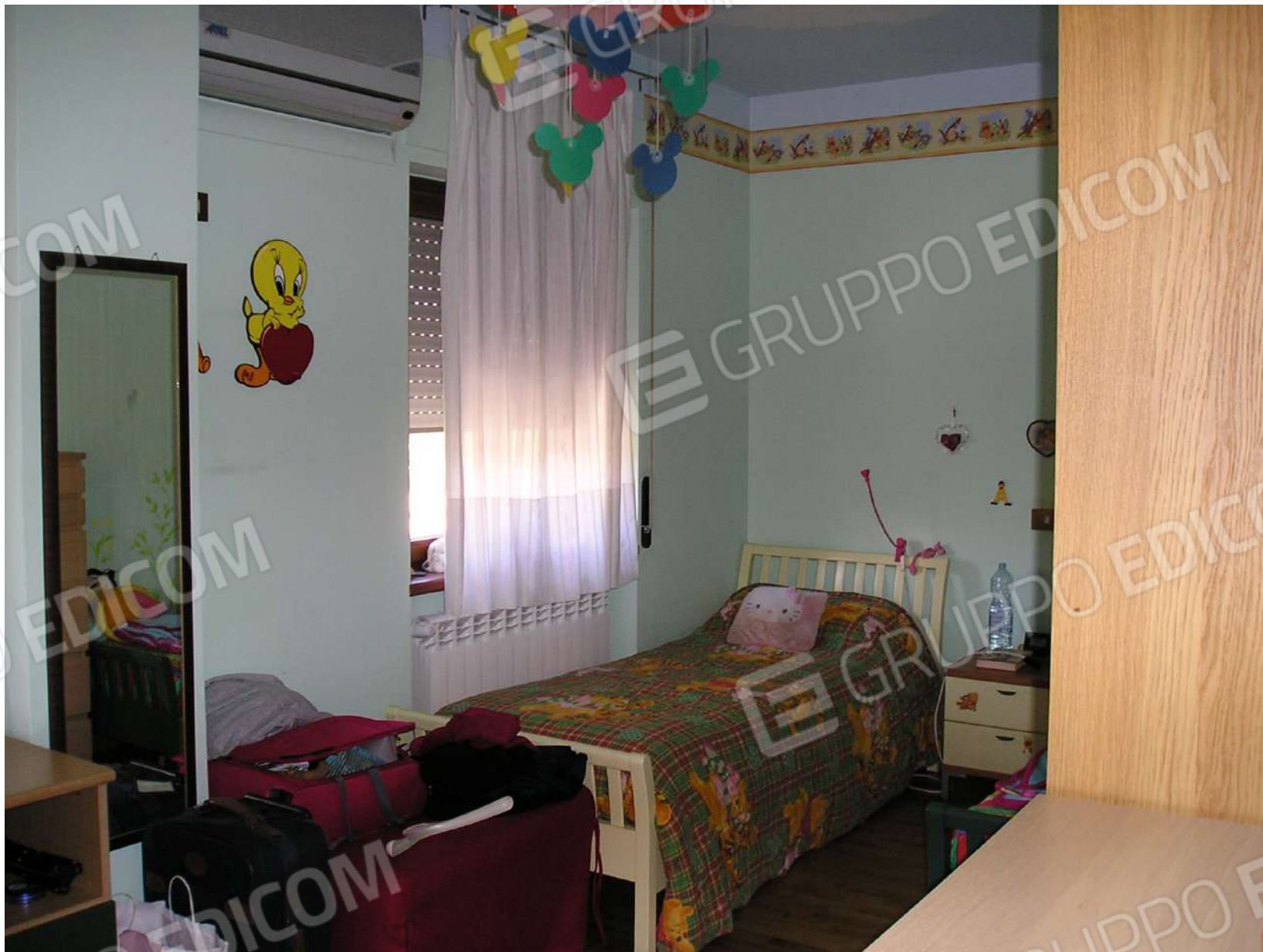
Foto n. 19: Camera da letto con abuso edilizio
