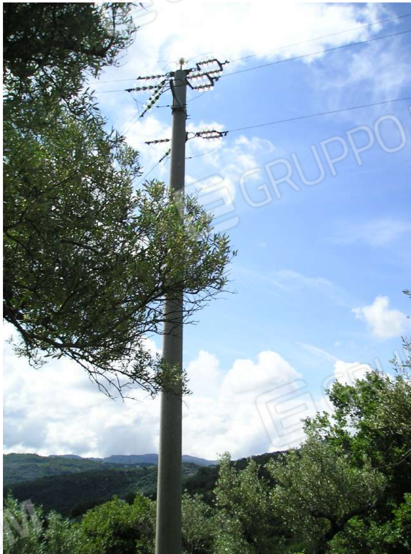
Foto n. 41: Immobile 3 – particolare elettrodotto
