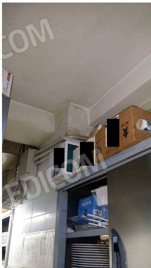
Foto n. 31 – macchie umidità cucina
