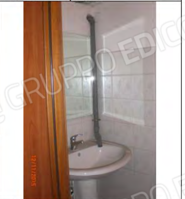
Foto n. 12: Particolare del servizio posto a quota S1
