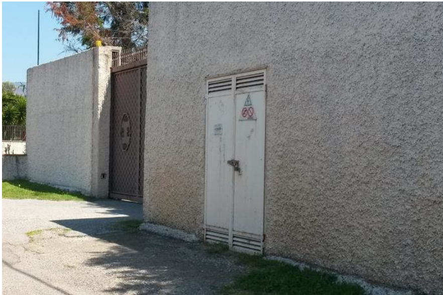
Foto n° 78- Cabina elettrica – Ingresso da via Degli Uliveti
