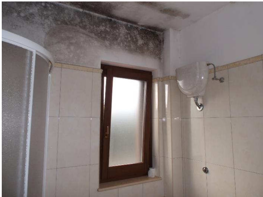
Foto n° 21- Piano primo - Particolare presenza macchie di umidità nel bagno n° 2 (Sub 8)
