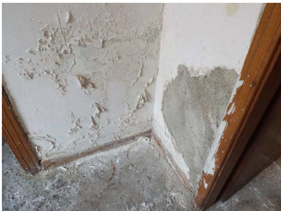
Foto n° 96- Piano terra - Particolare presenza macchie di umidità di risalita nel disimpegno
