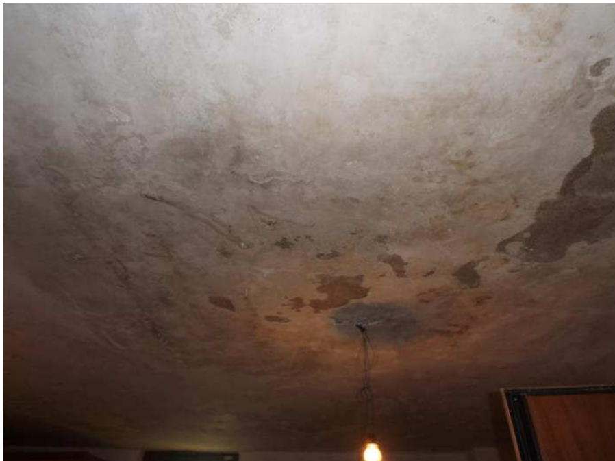
Foto n° 47- Piano interrato - Particolare presenza di infiltrazioni nel garage (Sub 7)
