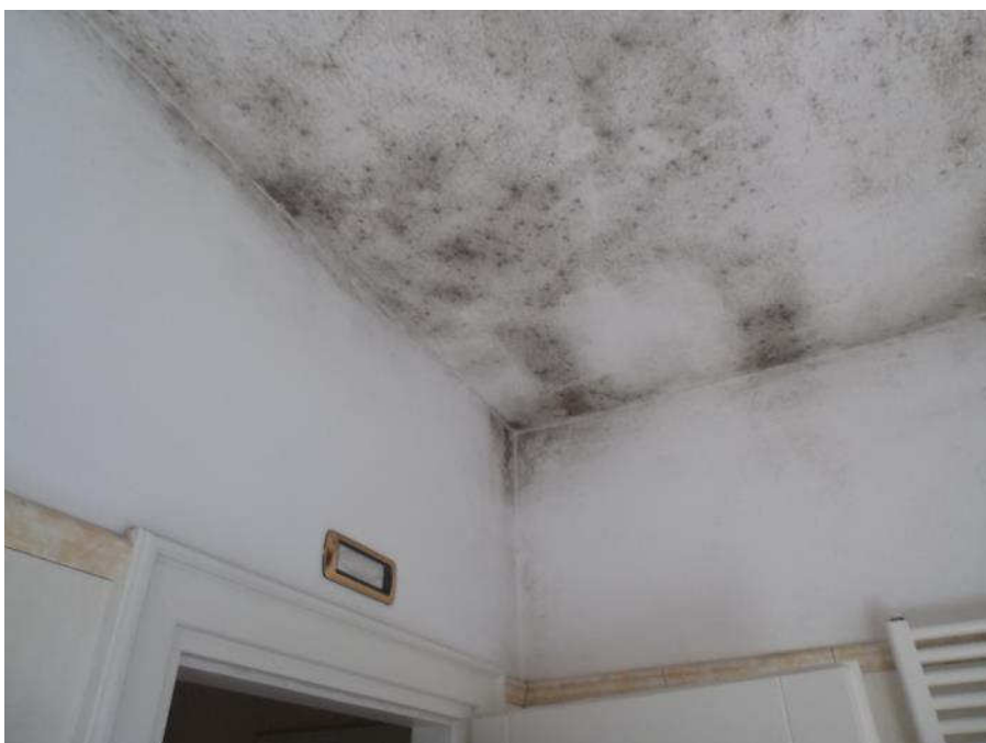
Foto n° 20- Piano primo - Particolare presenza macchie di umidità nel bagno n° 2 (Sub 8)
