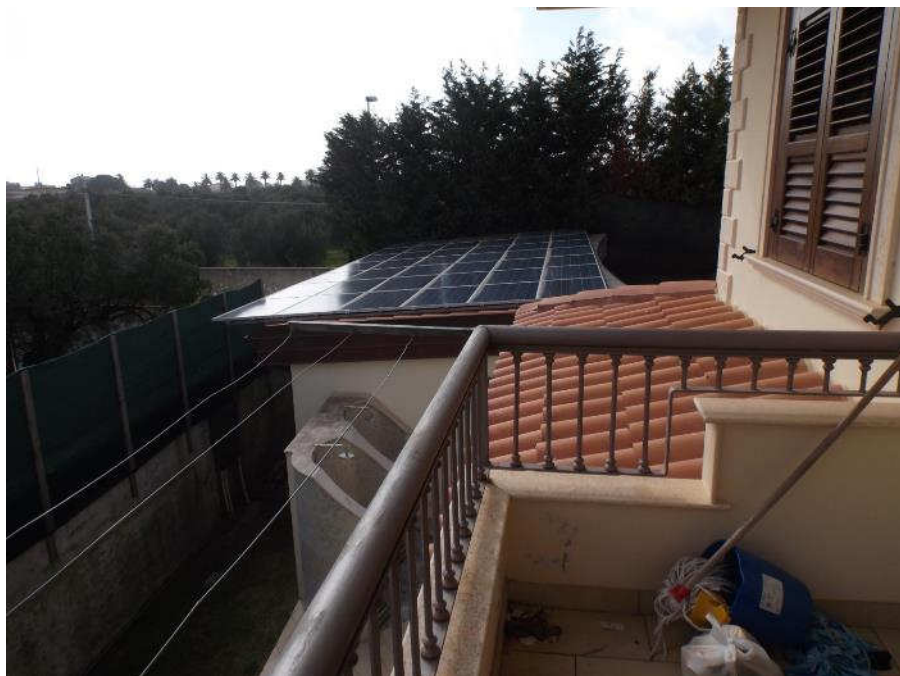
Foto n°58 - Particolare impianto solare realizzato su locale annesso alla piscina
