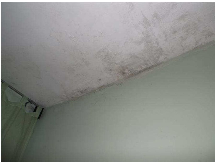
Foto n° 118 - Piano primo - Presenza macchie di umidità nella camera da letto n° 2
