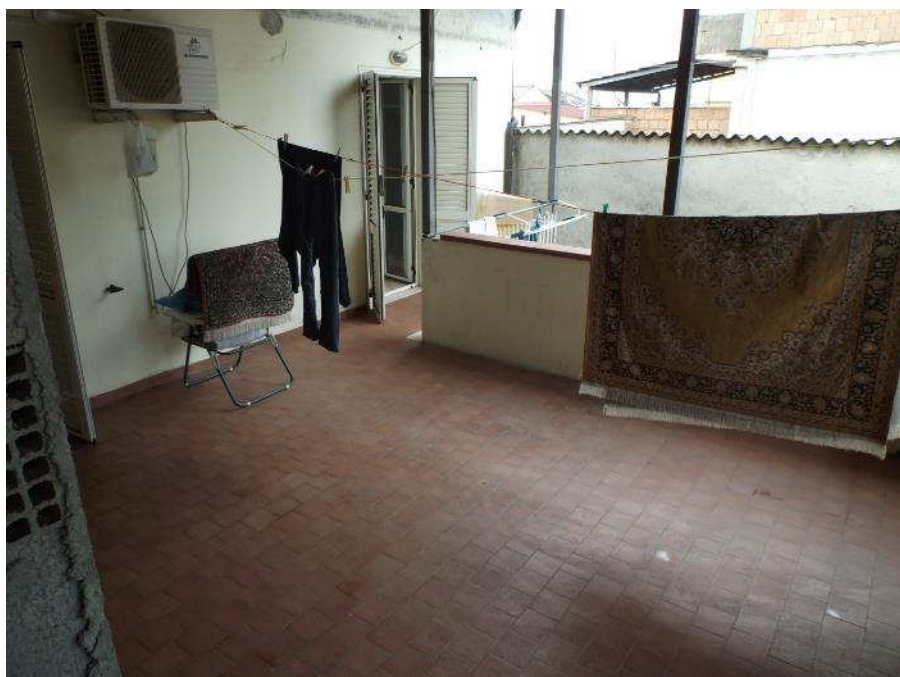
Foto n° 138 - Piano primo – Terrazzo abusivo
