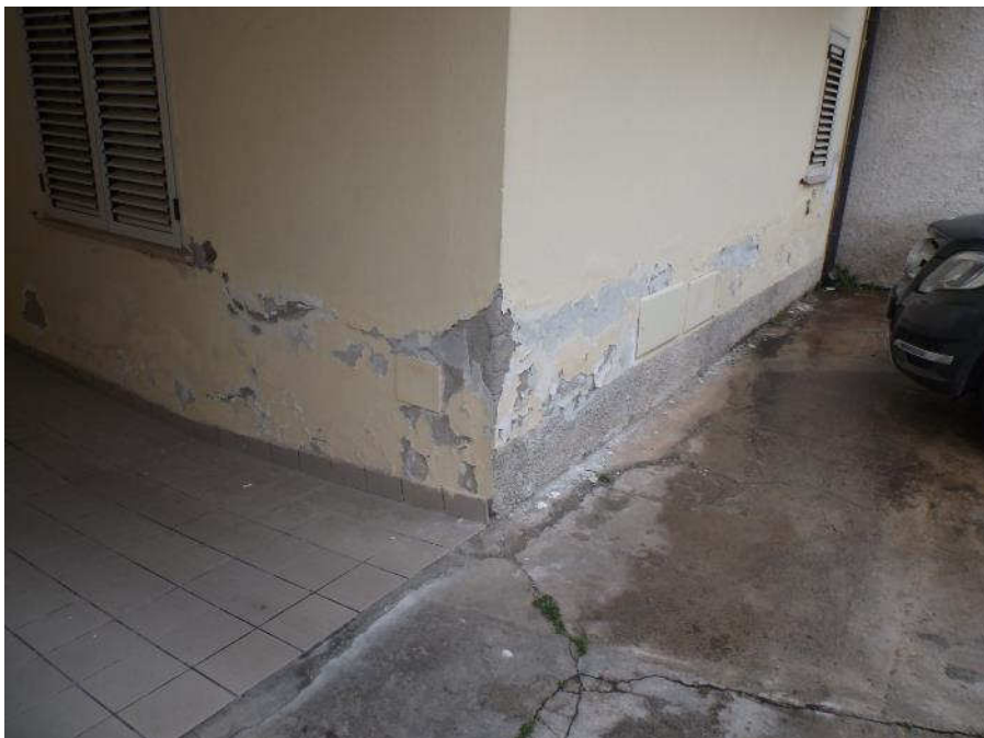
Foto n°122 - Particolare presenza umidità di risalita sul prospetto sud ed est
