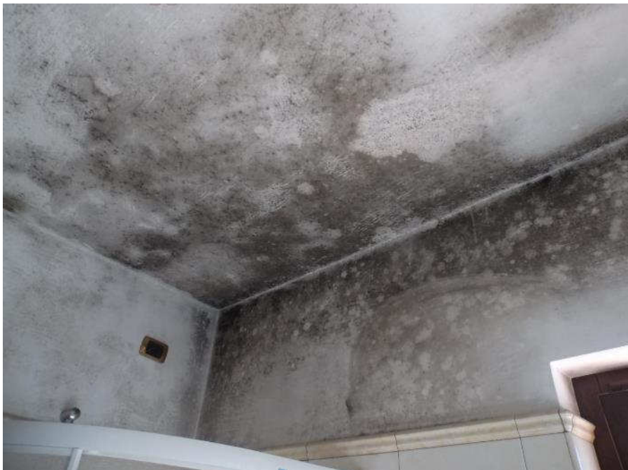
Foto n° 19- Piano primo - Particolare presenza macchie di umidità nel bagno n° 2 (Sub 8)
