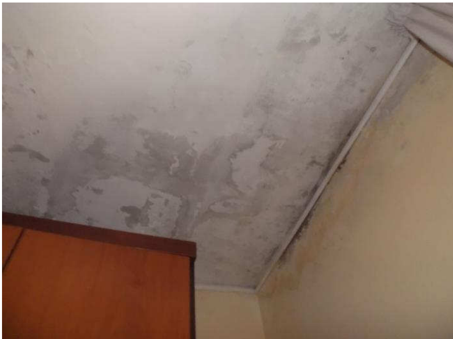
Foto n° 115 - Piano primo - Presenza macchie di umidità nella camera da letto n° 1
