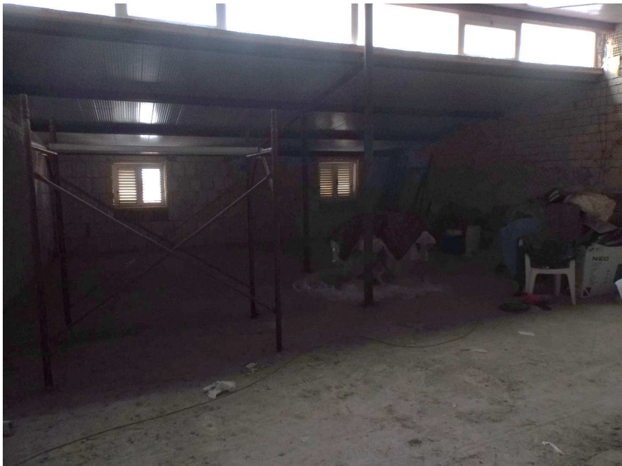
Foto n°141 - Piano sottotetto abusivo - Ambiente unico
