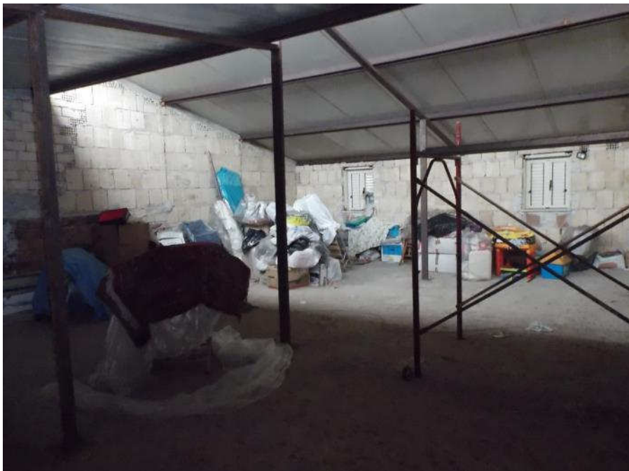
Foto n°143 - Piano sottotetto abusivo- Ambiente unico
