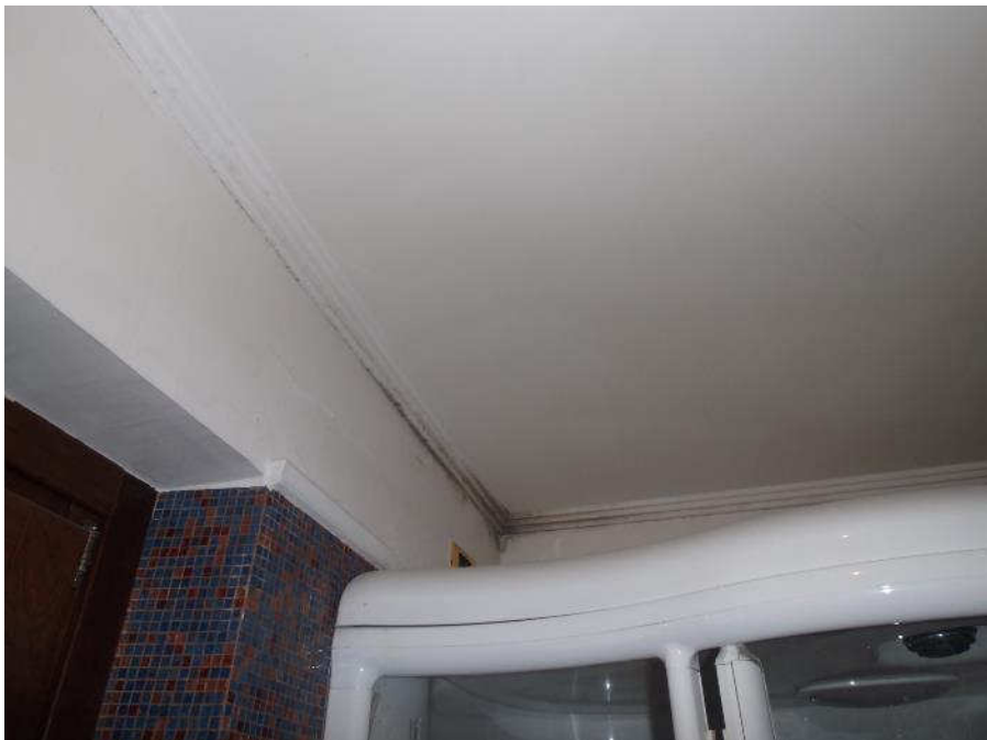
Foto n° 33 - Piano primo - Particolare presenza macchie di umidità nel bagno n° 3 (Sub 9)
