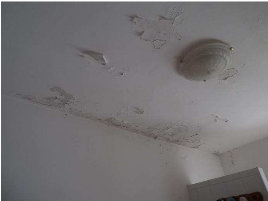
Foto n° 135 - Piano primo - Particolare presenza macchie di umidità nella lavanderia-stireria
