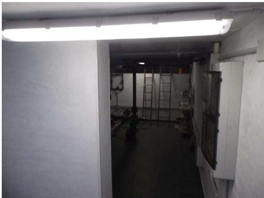
Foto n° 65 - Piano interrato - Locale tecnico
