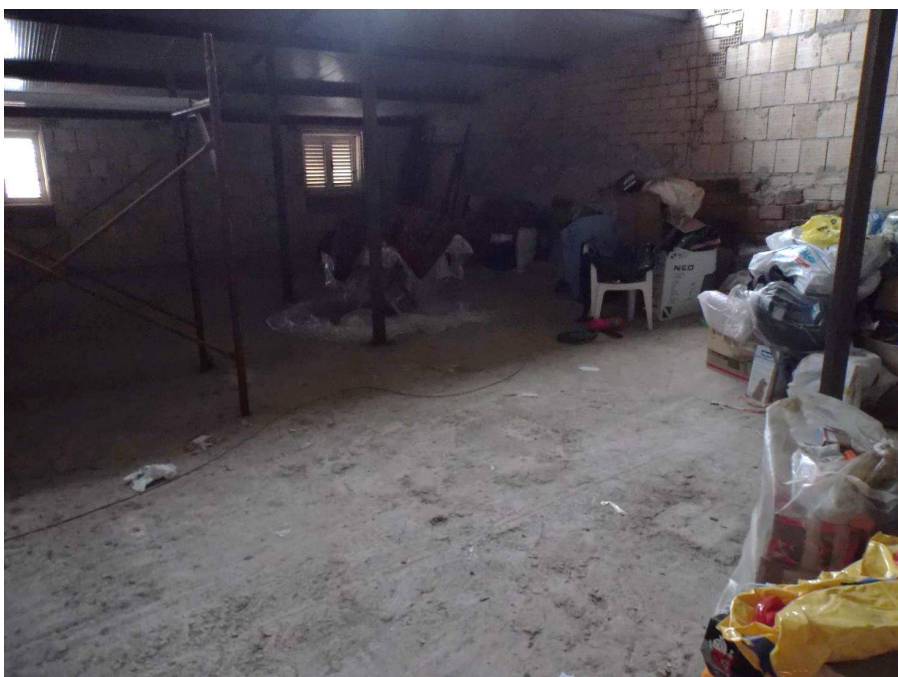
Foto n° 142 - Piano sottotetto abusivo - Ambiente unico
