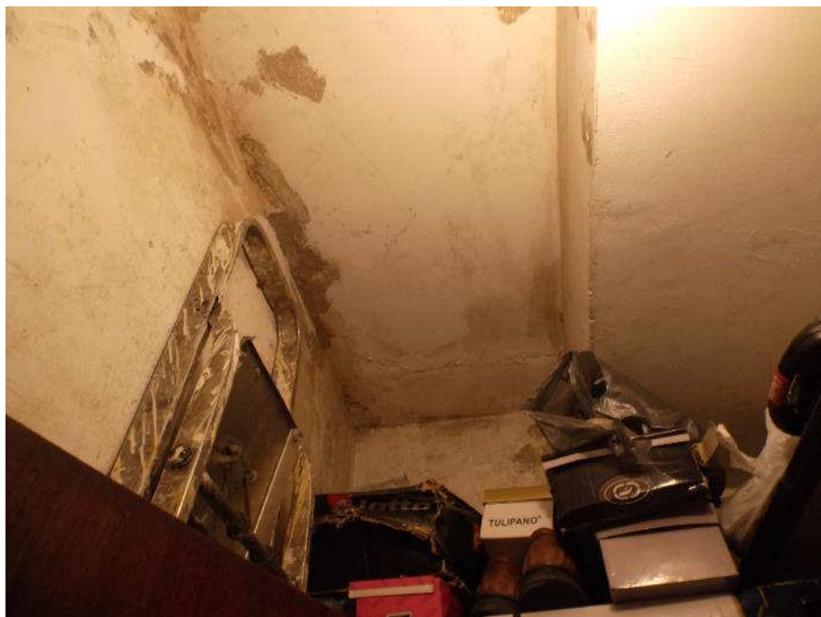
Foto n° 112 - Piano primo - Particolare presenza macchie di umidità nel ripostiglio
