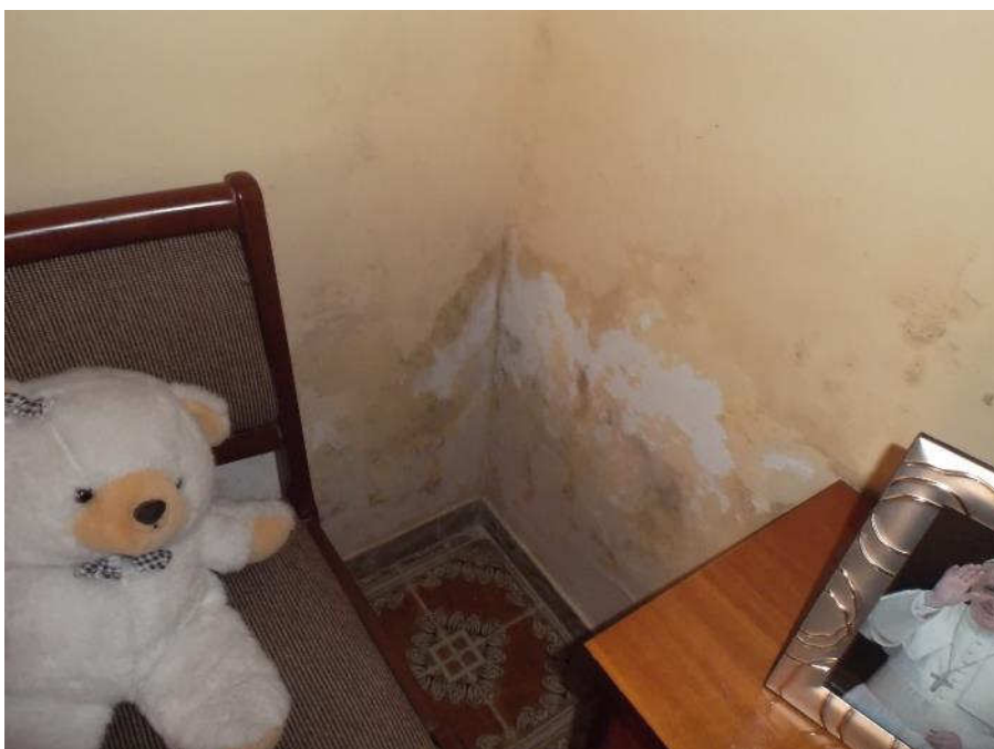
Foto n° 116 - Piano primo - Presenza macchie di umidità nella camera da letto n° 1
