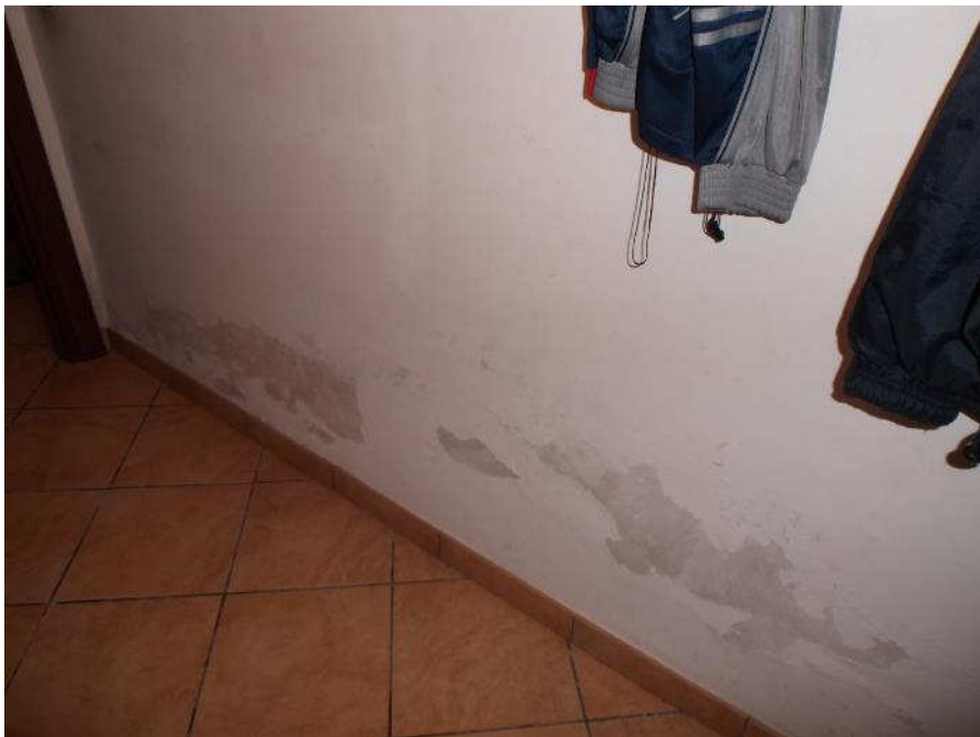
Foto n°126 - Piano terra - Particolare presenza macchie di umidità di risalita nel disimpegno
