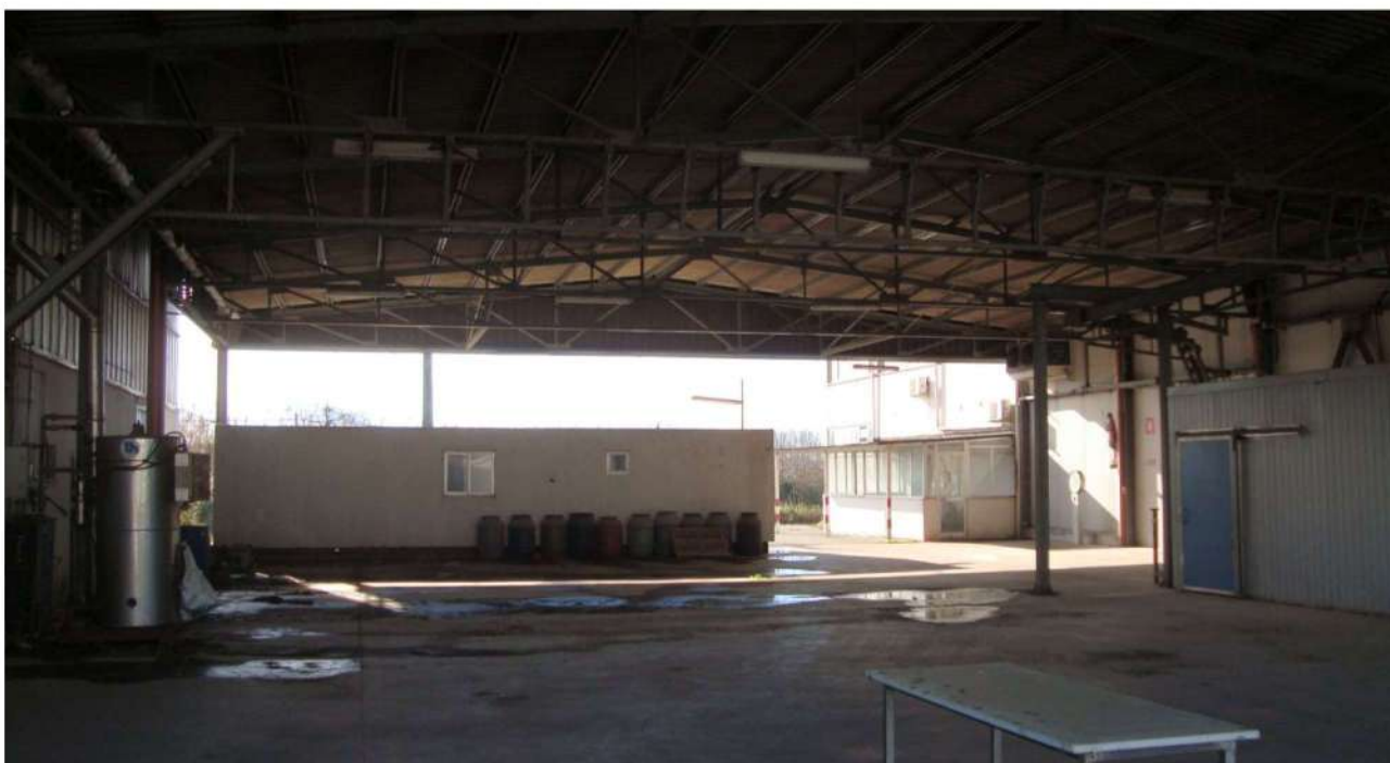
■ Figura 29 vista interna della tettoia del fabbricato opificio della particella 52 foglio 32 comune di Lamezia Terme
