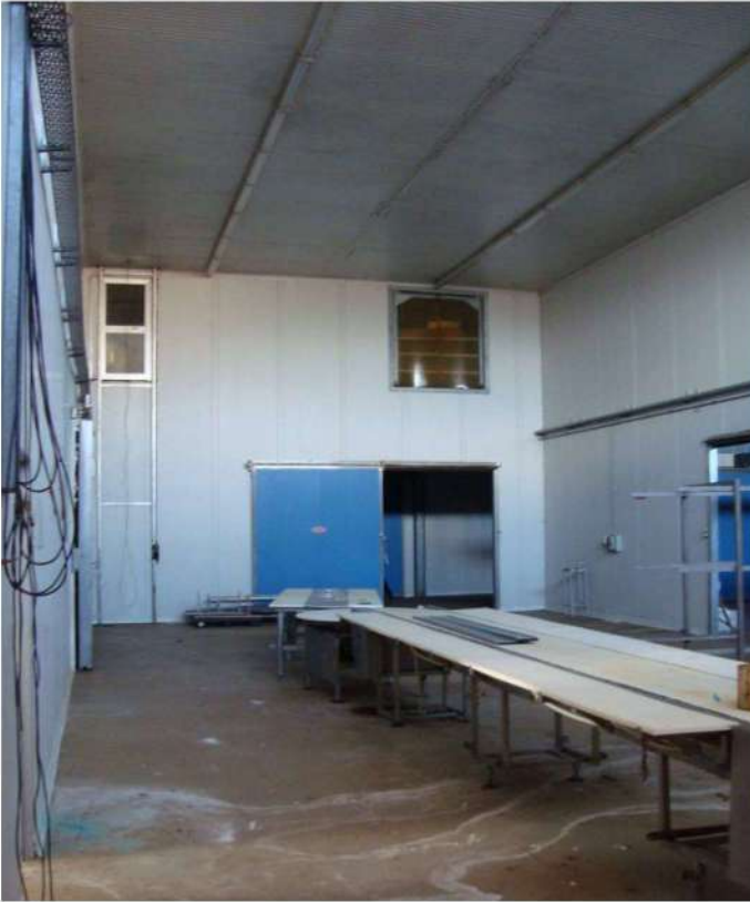
■ Figura 26 vista interna della calla del fabbricato opificio della particella 52 foglio 32 comune di Lamezia Terme
