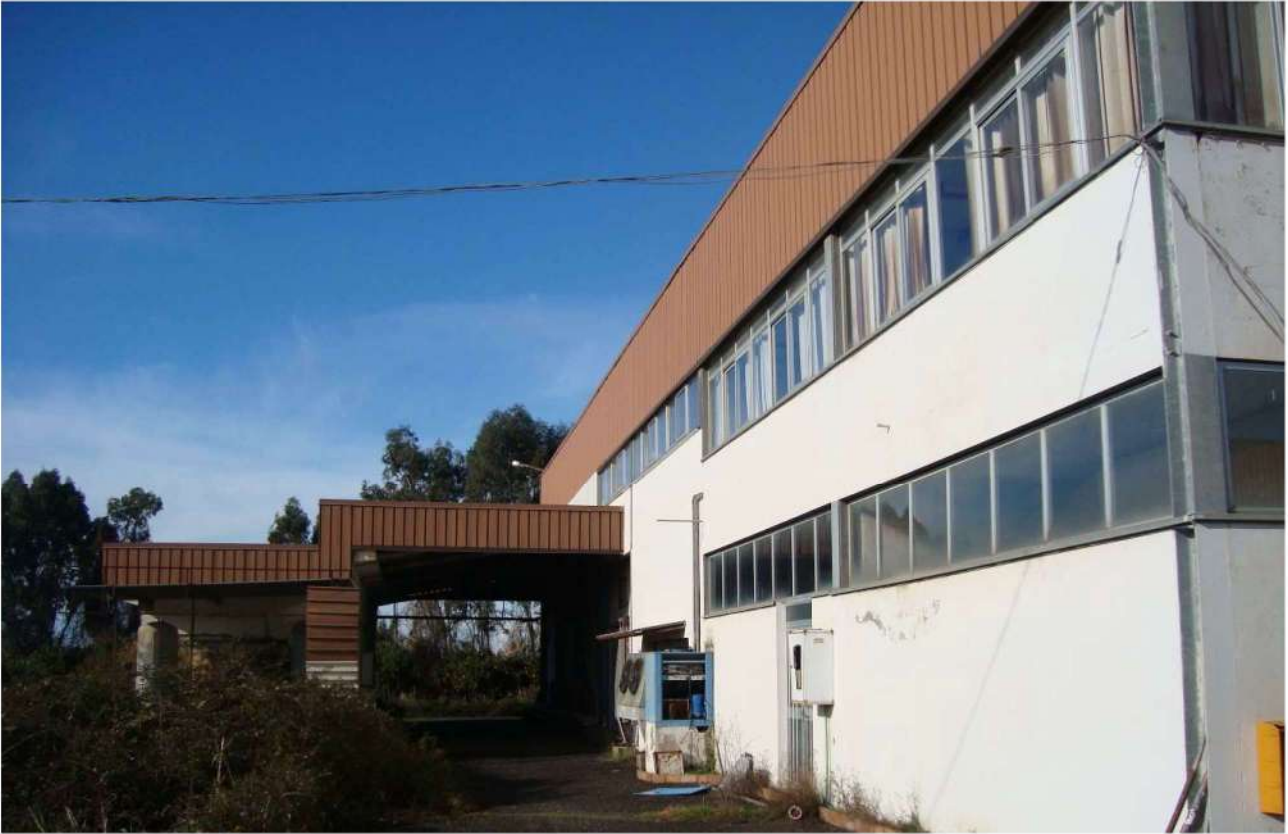
■ Figura 24 vista del fabbricato opificio della particella 52 foglio 32 comune di Lamezia Terme
