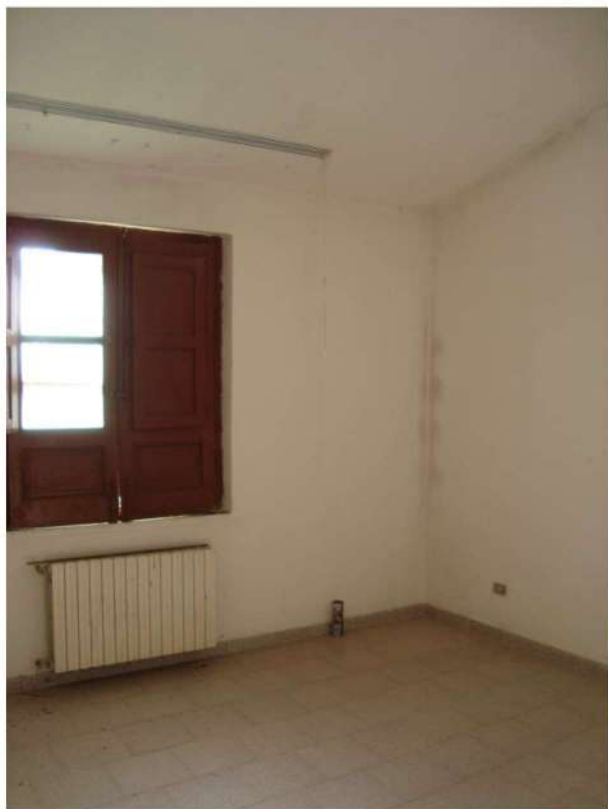
■ Figura 48 vista interna del fabbricato della particella 117 foglio 32 comune di Lamezia Terme
