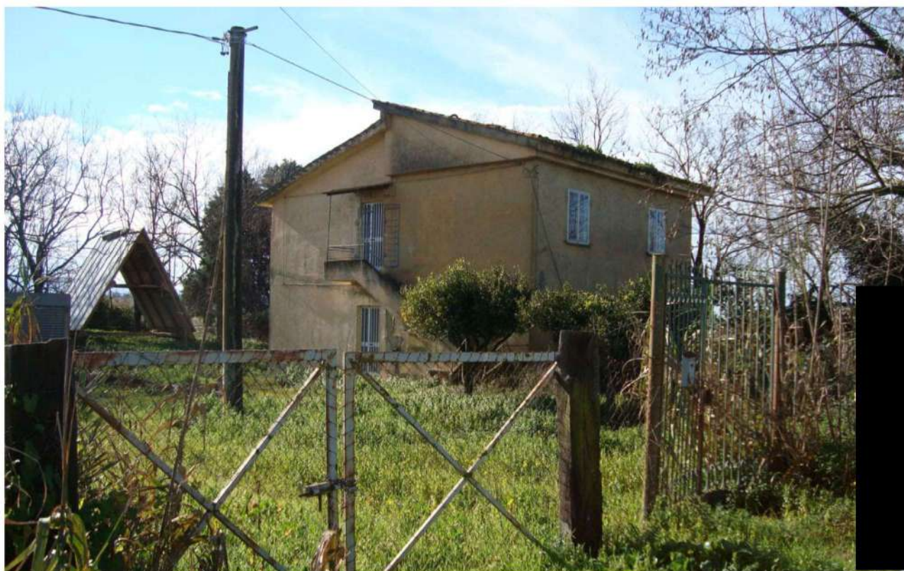
■ Figura 45 vista esterna del fabbricato della particella 117 foglio 32 comune di Lamezia Terme
