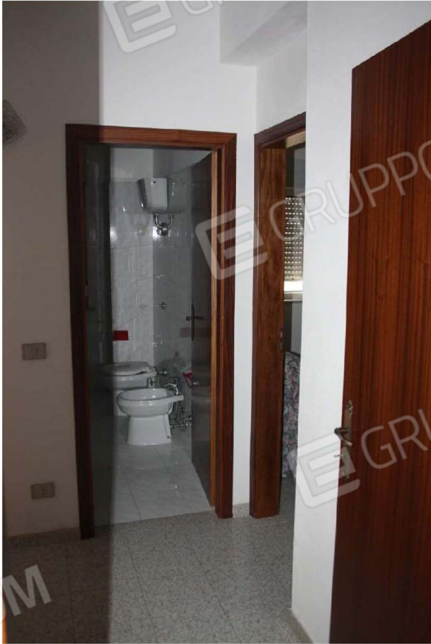
Foto n°14 – Vista del disimpegno prospiciente le camere da letto, con vista del bagno principale
