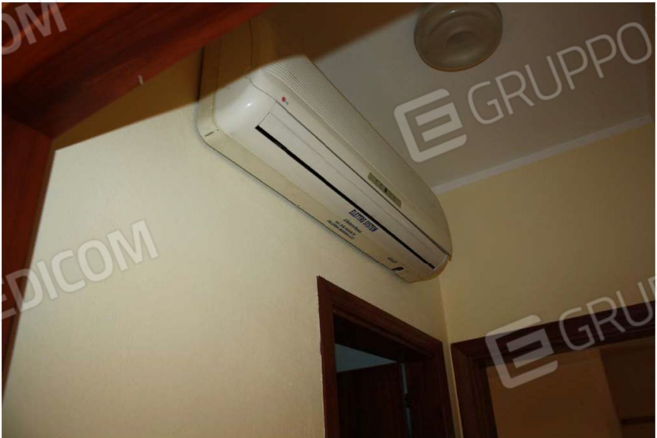
Foto n°9 – Aria condizionata installata
