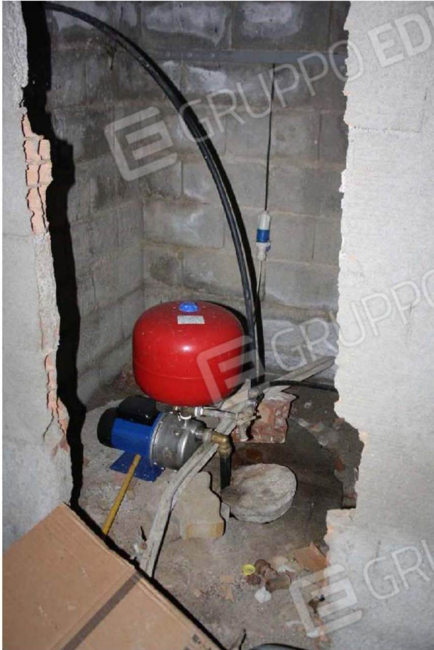
Foto n°10 – Pompa di sollevamento
