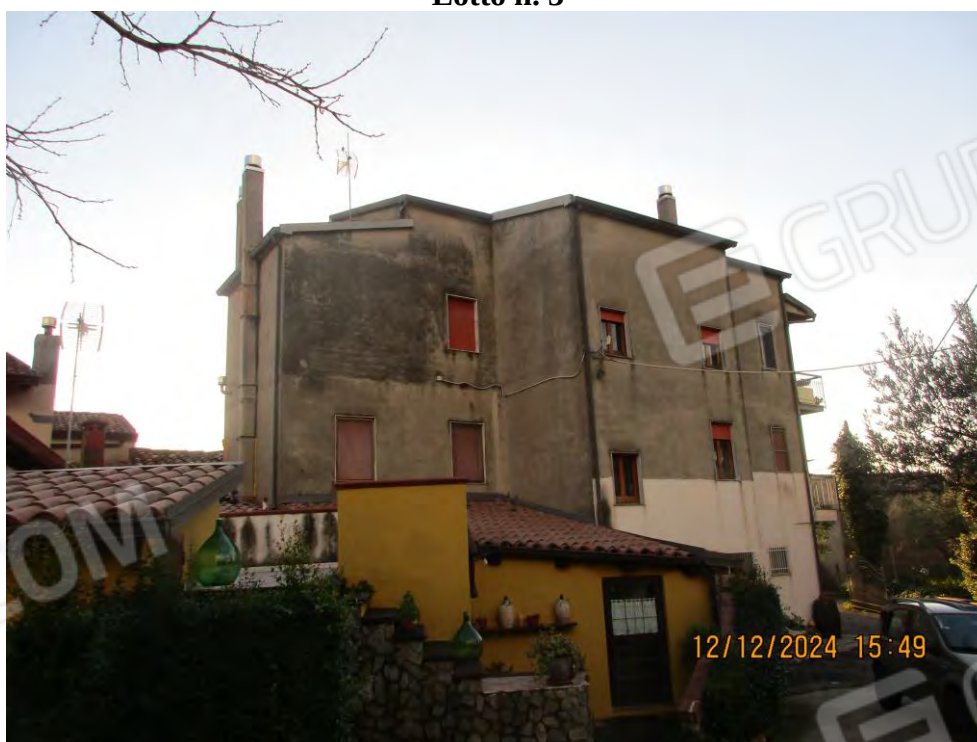
Foto n. 30 – Ampliamento abusivo fabbricato censito con la particella 269
