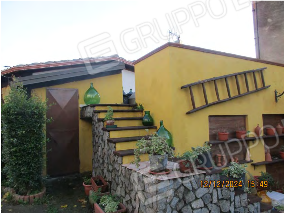
Foto n. 31 – Ampliamento abusivo fabbricato censito con la particella 269
