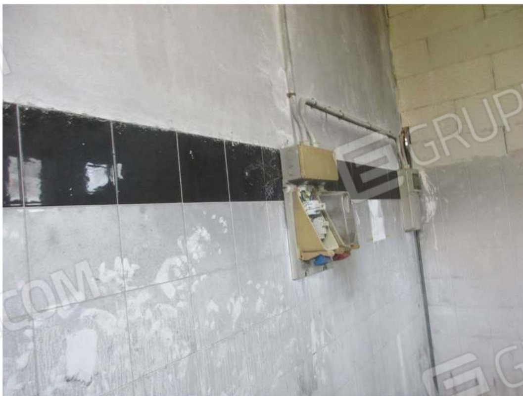
Foto 30: Immagine descrittiva dello stato dell'impiantistica elettrica
