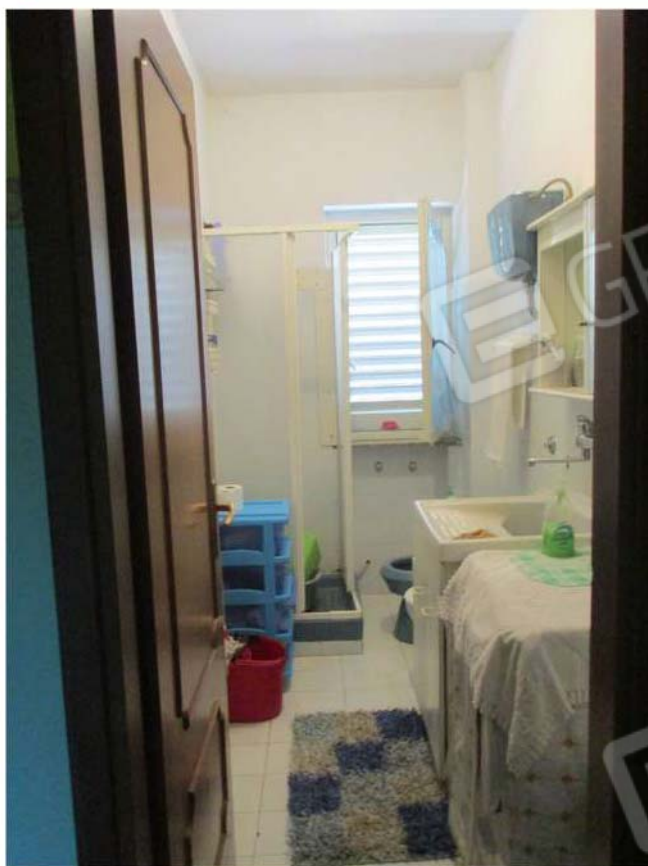
Foto 65: Il primo servizio igienico
