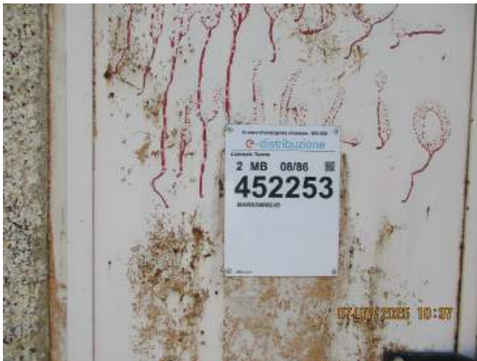
Foto n. 2 – Identificativi Cabina elettrica
