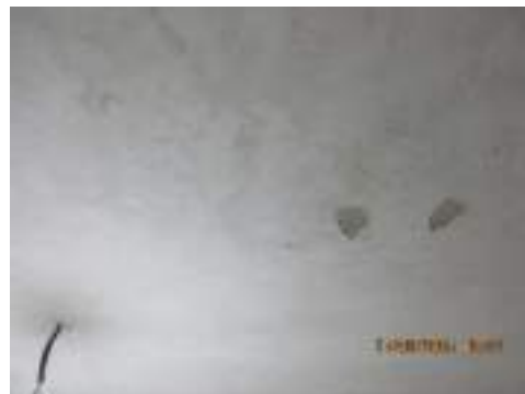
Foto n. 29 – Infiltrazioni Garage – sub 7
