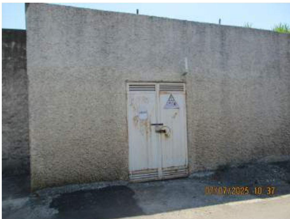
Foto n. 1 – Particolare Cabina elettrica
