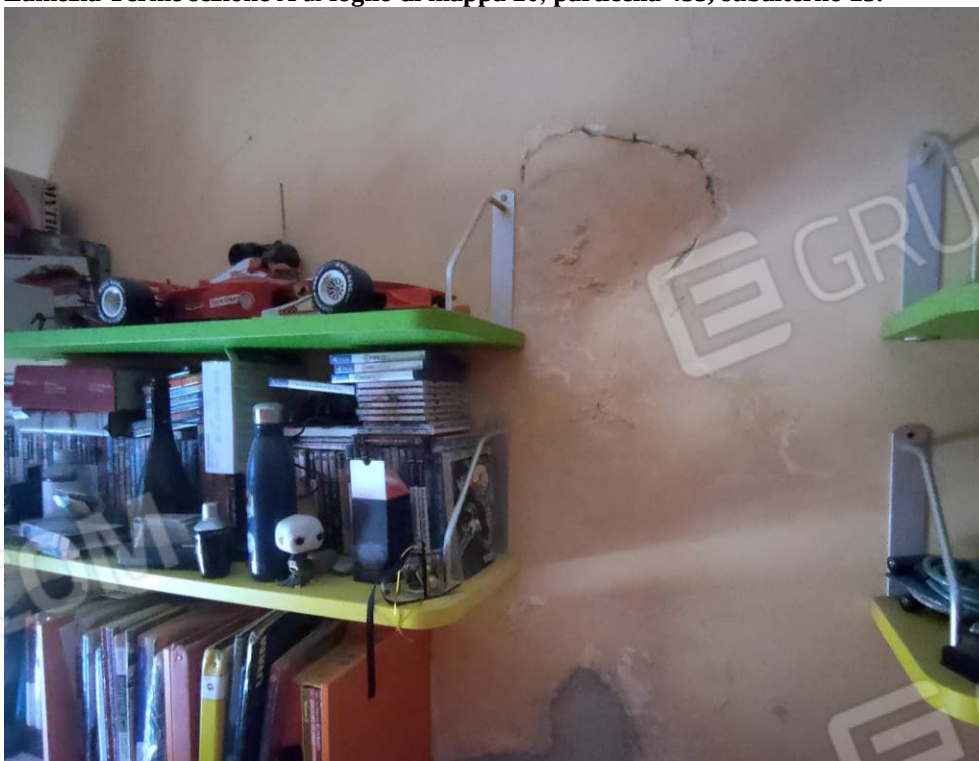
Foto n. 25: Macchia di umidità presente nella camera da letto indicata con la sigla L2 nella planimetria allegata, relativa all'unità ubicata al piano quinto del fabbricato censito in catasto fabbricati del comune di Lamezia Terme sezione A al foglio di mappa 20, particella 455, subalterno 25.
