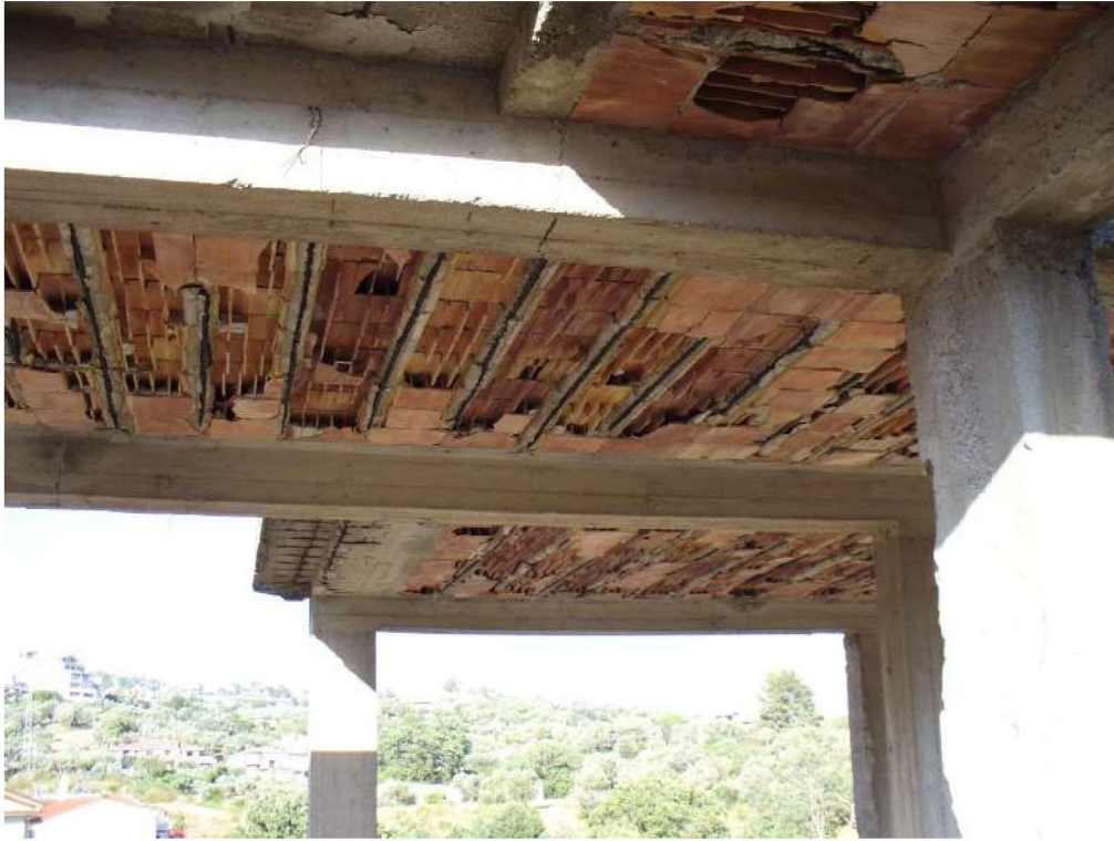
FOTO N. 3 – condizione del solaio di copertura dell’abbaino –
