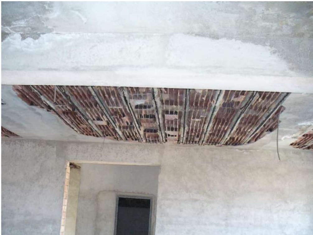
FOTO N. 4 – condizione del solaio di copertura del lastrico solare –
