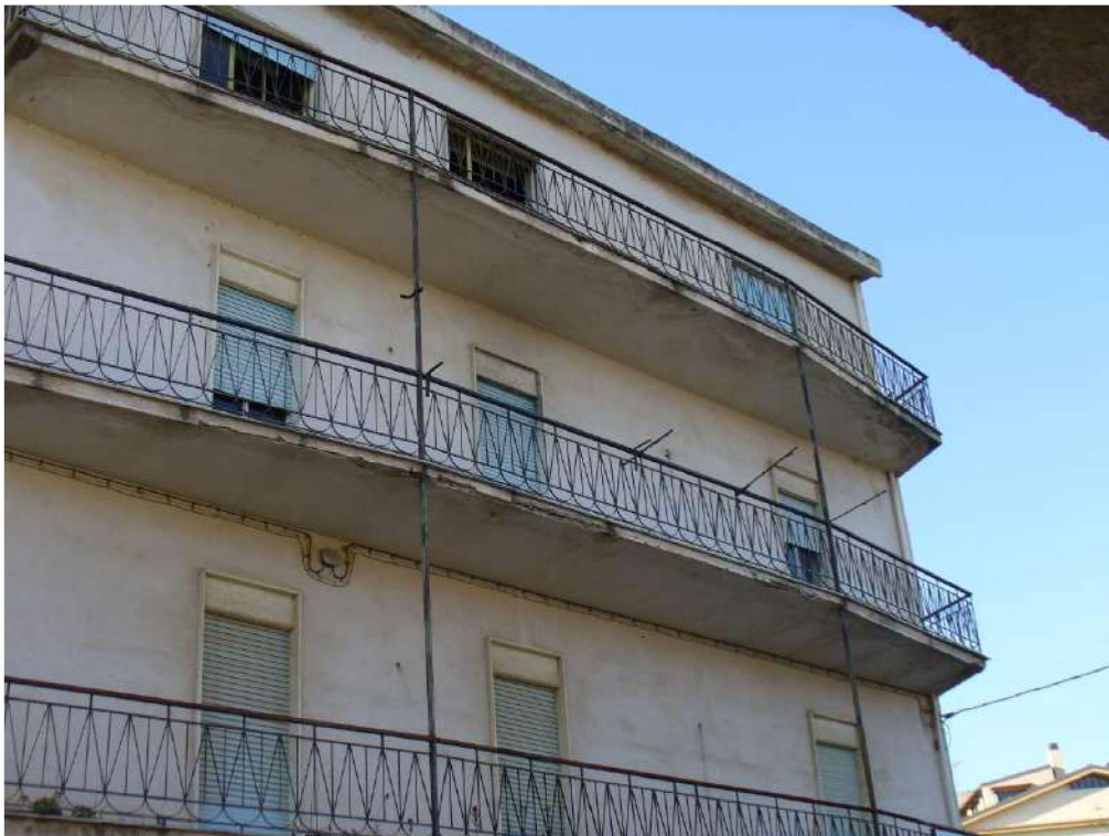
FOTO N. 2 – condizione degli sbalzi (balconi) sporgenti verso la corte –
