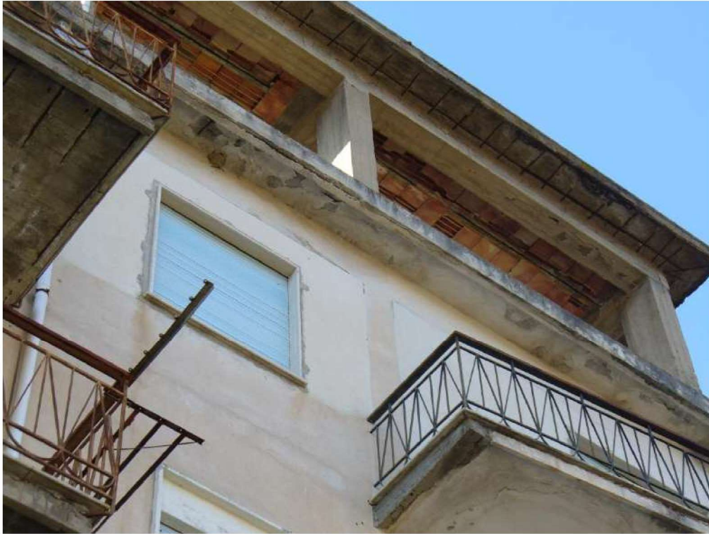
FOTO N. 1 – condizione degli sbalzi (cornicioni) sporgenti verso la corte –
