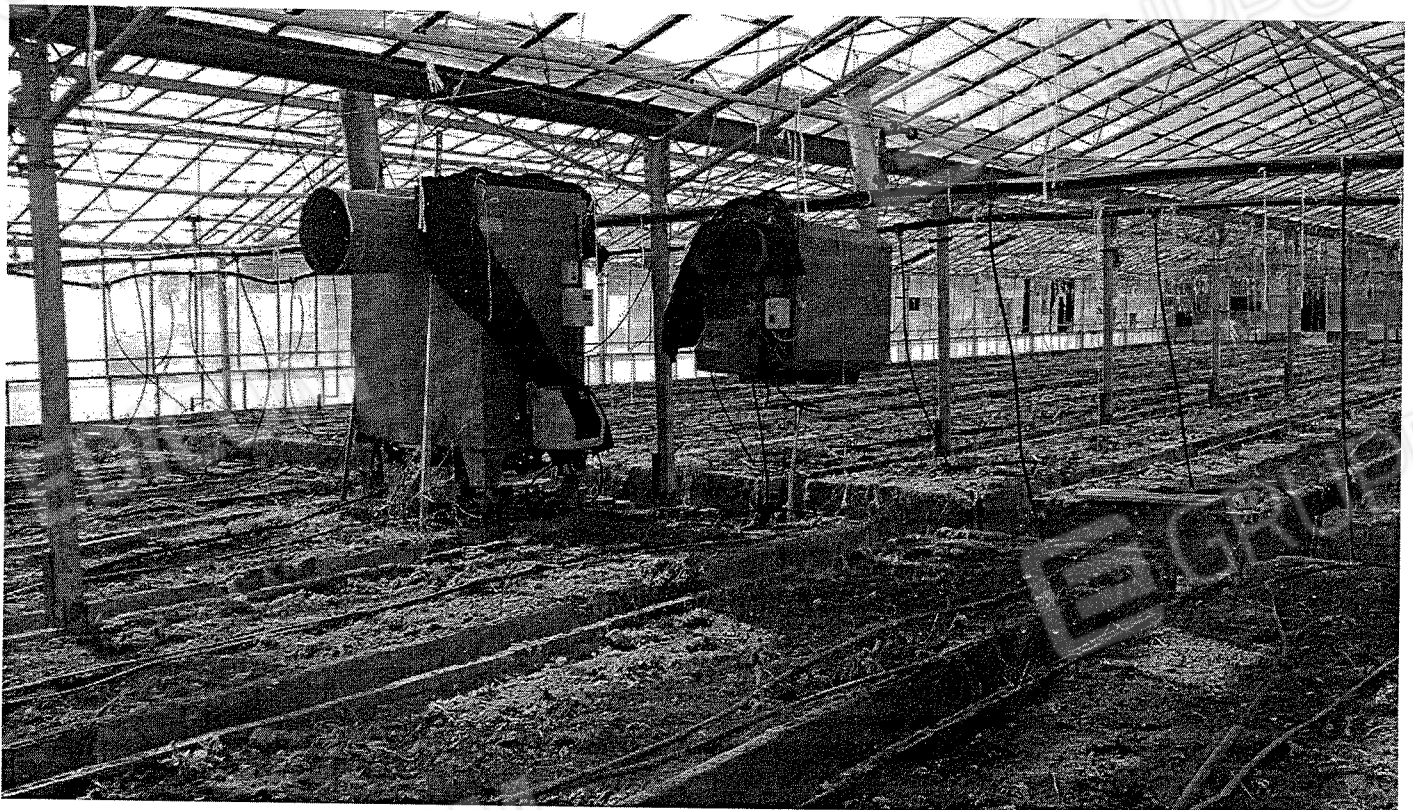
Figura 4. Immagine interna, in evidenza i due tipi di bruciatori per il riscaldamento dell'aria.
