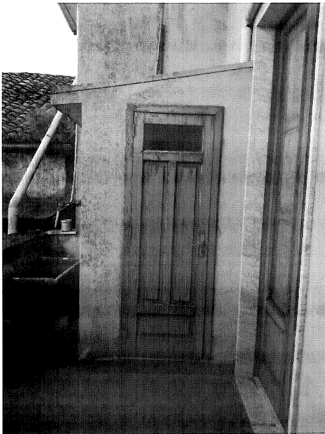
Foto 10: Catasto Fabbricati di Cittanova, foglio 73, particella 1237 sub 3 – primo piano. w.c. esterno, costruito sul terrazzino comunicante con la cucina.
