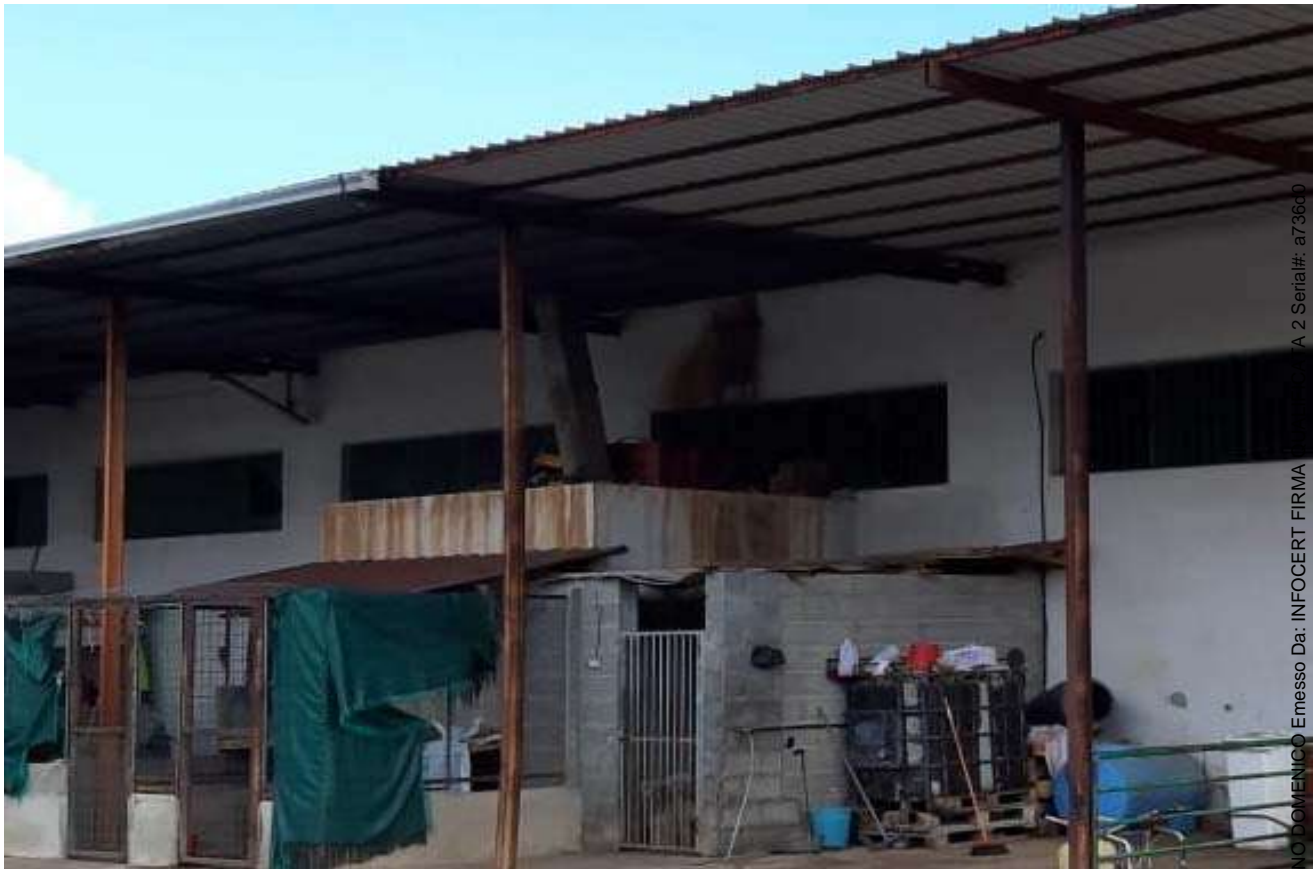
LOTTO 002 – FOTO 20 – Particolare della tettoia esterna e del dispositivo di scarto per sanza esaur
