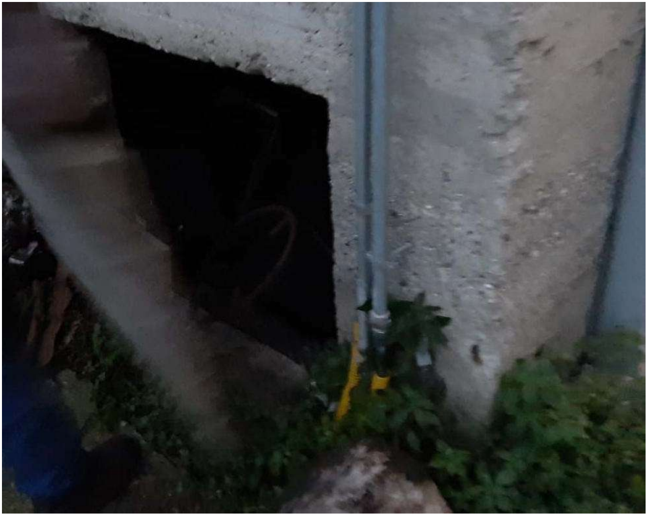
LOTTO 005 – FOTO 5 – Il varco sulla parete posteriore che da accesso al seminterrato
