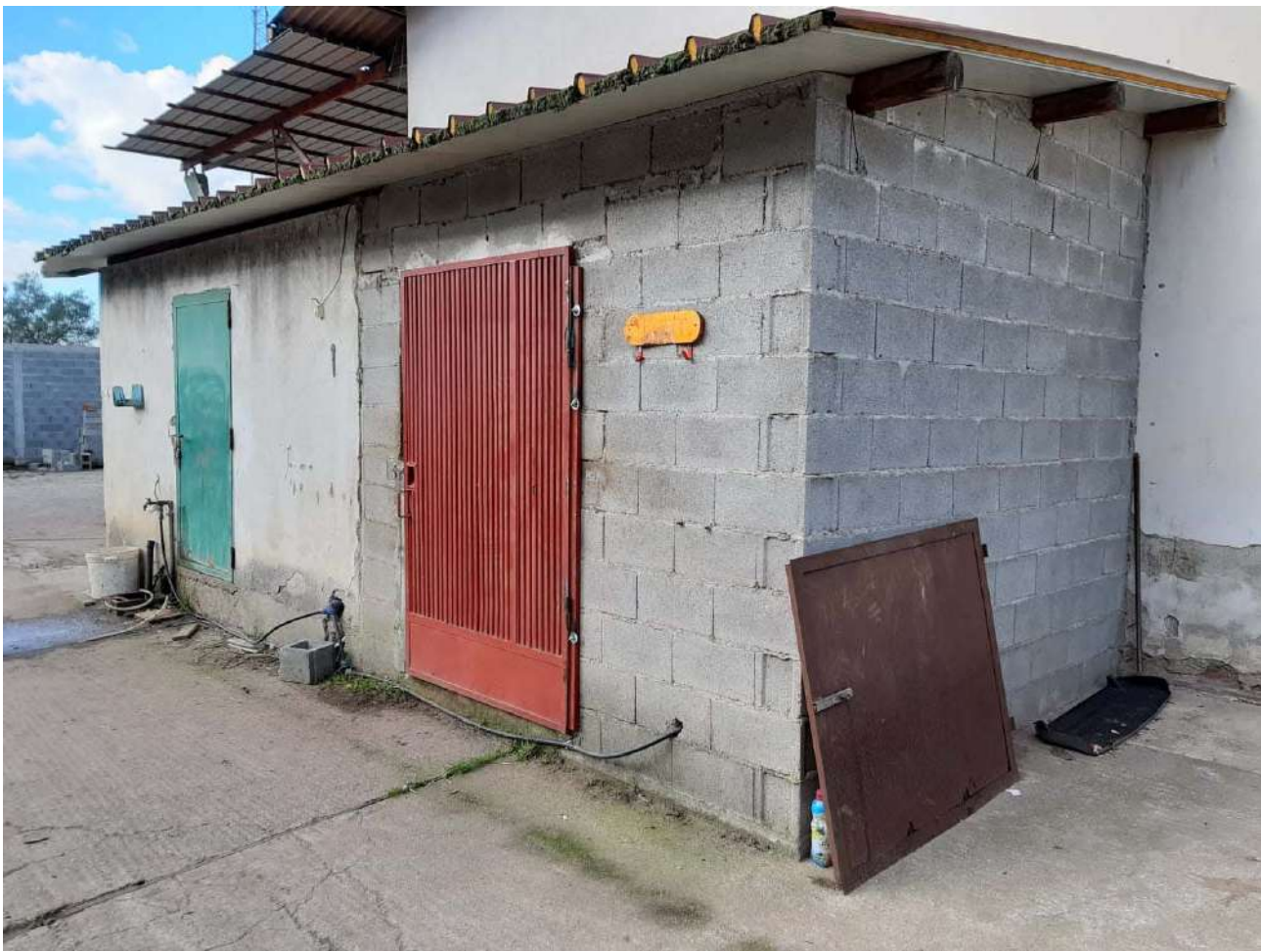
LOTTO 002 – FOTO 7 – Superfetazioni a ridosso della parete Sud del capannone
