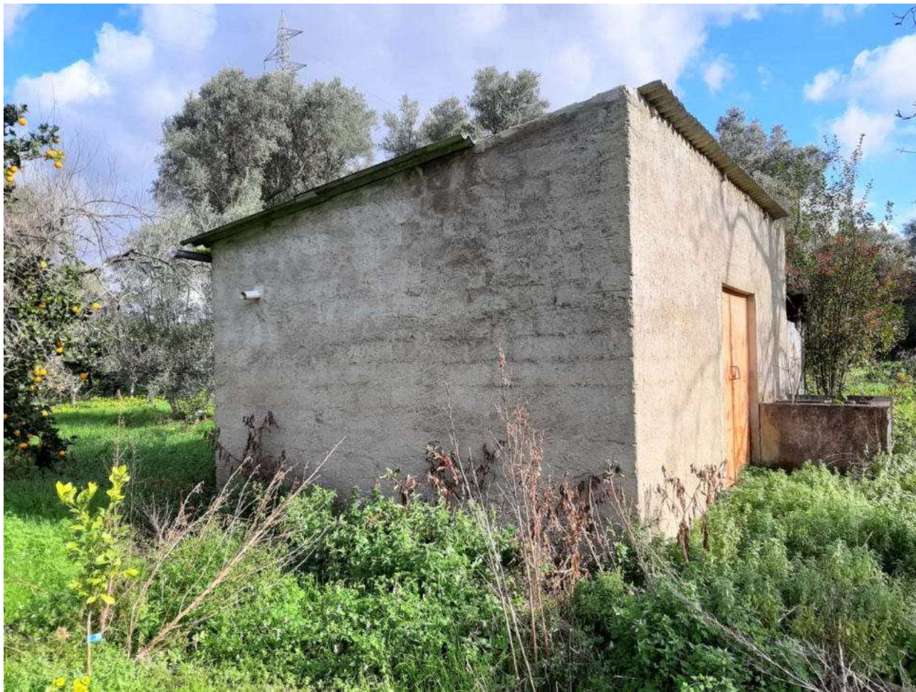
LOTTO 003 – FOTO 5 – Fabbricato a semplice elevazione in stato di abbandono
