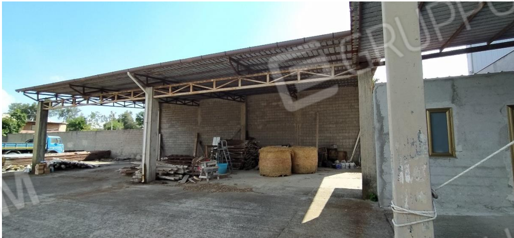
Foto 6: Catasto Fabbricati di Gioia Tauro, foglio 33, particella 392. Sulla sinistra, tettoia in c.a. descritta al punto "f"; sulla destra, tettoia e fabbricato descritti ai punti "d" ed "e".
