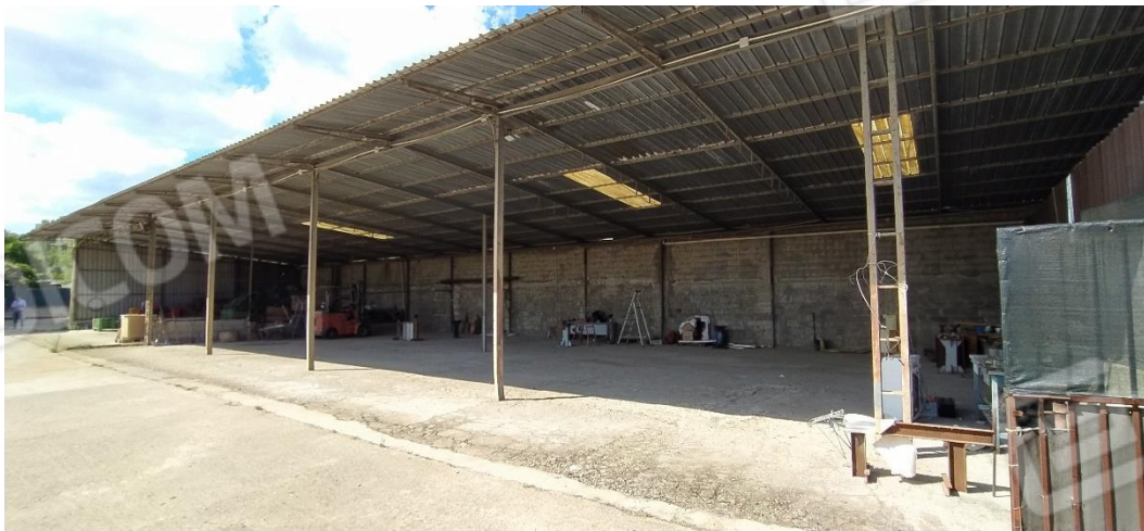
Foto 7: Catasto Fabbricati di Gioia Tauro, foglio 33, particella 392. Tettoia con struttura metallica descritta al punto "g".
