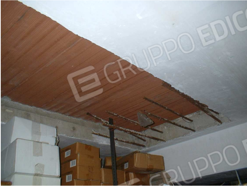
Foto 9- Dettaglio porzione solaio ammalorato
