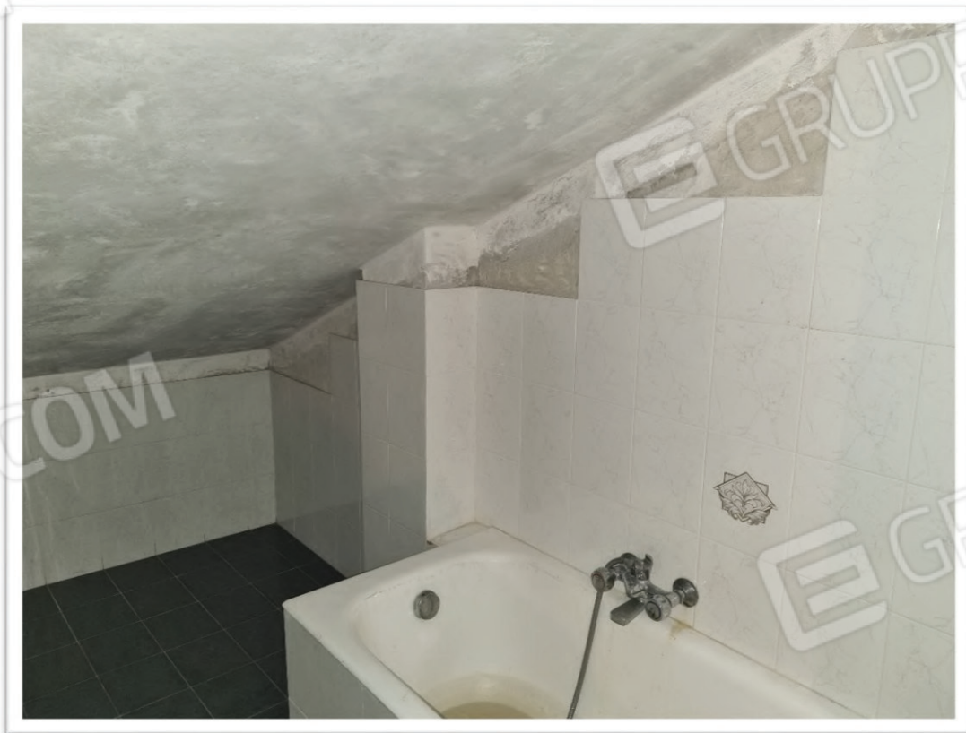
Foto 8 – Particolare rifiniture mancanti Bagno
