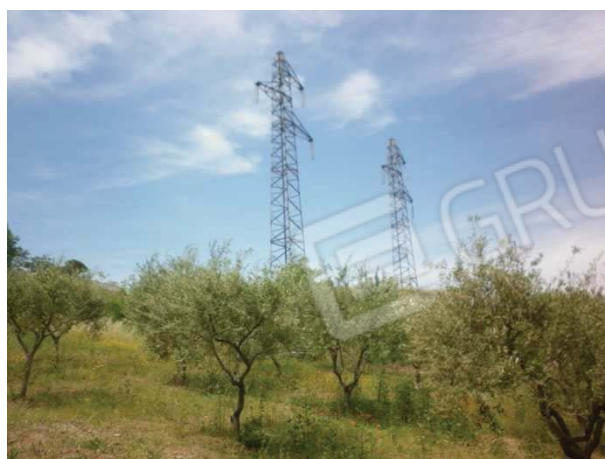
Foto 16 - P.Ila 40, tralicci elettrodotto
