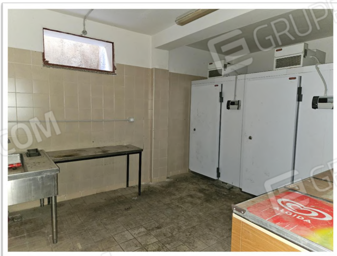
Foto 24 – Locale celle frigorifere – piano seminterrato
