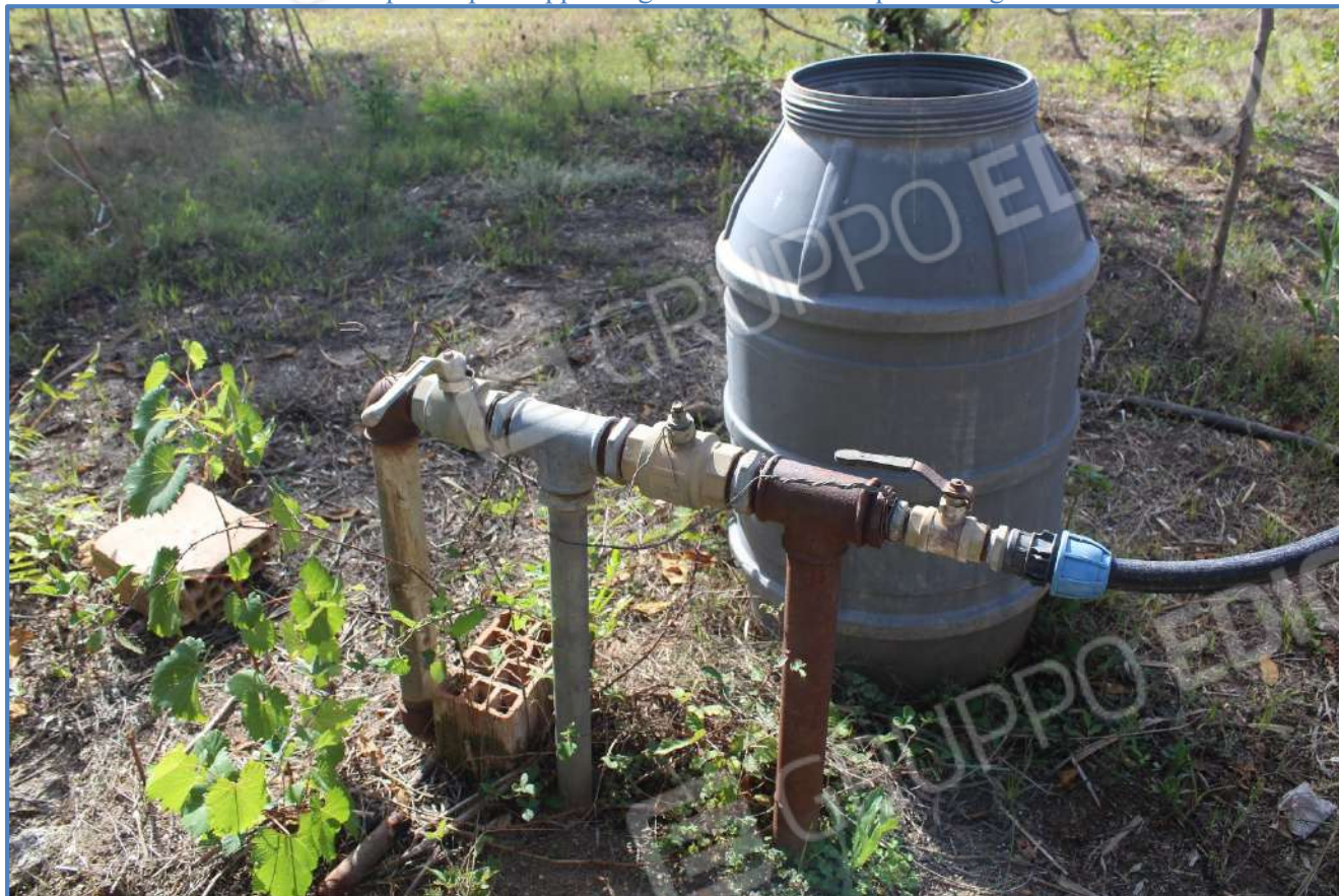
3.19 – Vista sul serbatoio e l'impianto per l'approvvigionamento dell'acqua da irrigazione
