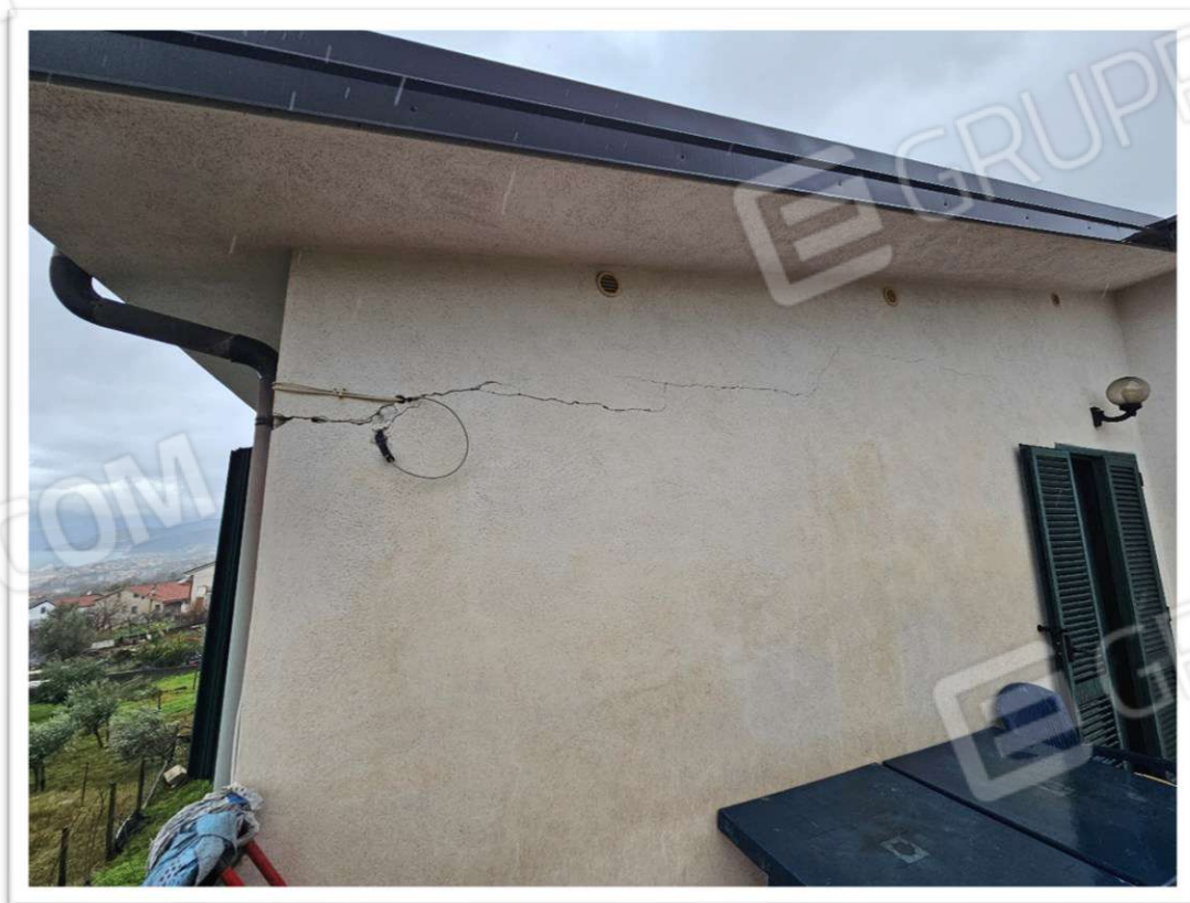
Foto 18 – Particolare lesione parete esterna stanza singola lato Sud
