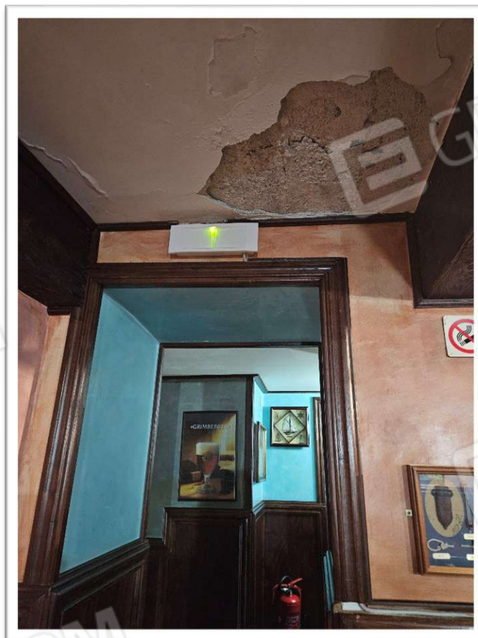
Foto 32 – Segni di degrado al soffitto della zona soppalco
