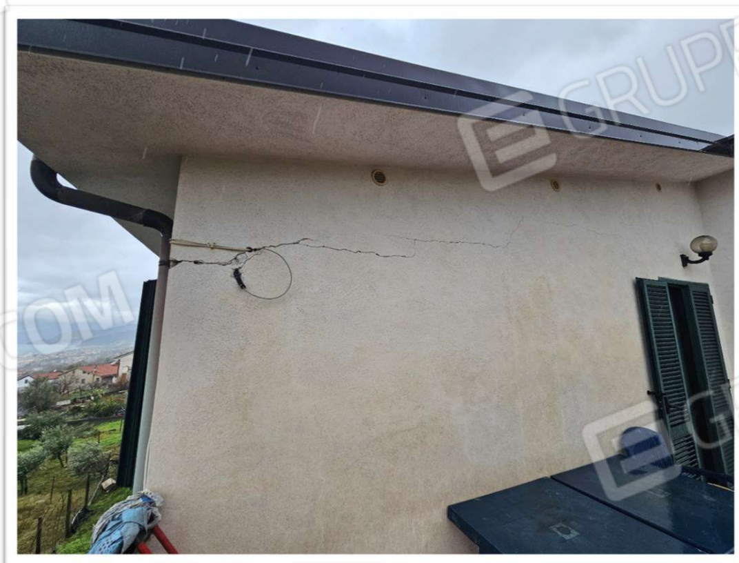
Foto 18 – Particolare lesione parete esterna stanza singola lato Sud
