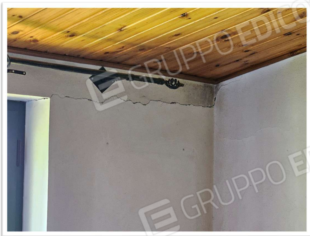
Foto 15 – Particolare lesione presente nella stanza singola lato Nord
