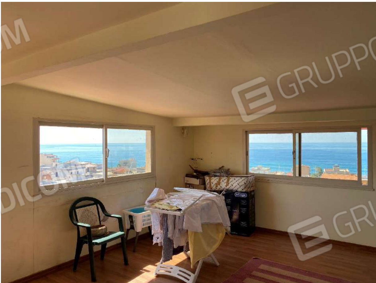
Foto n. 145. Camera settimo piano f.t. evidenti problemi murari
