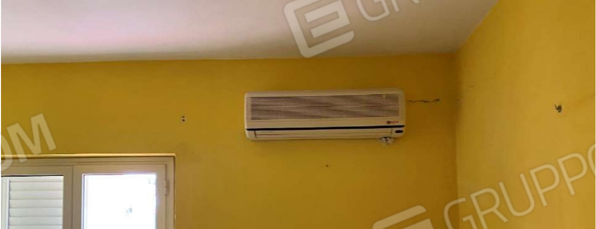
Foto n. 87, n. 88. Finiture camera. Problemi alla partizione muraria
