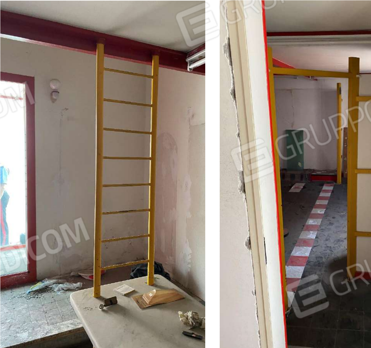
Foto n. 33, n. 34. Finiture interne compromesse.
