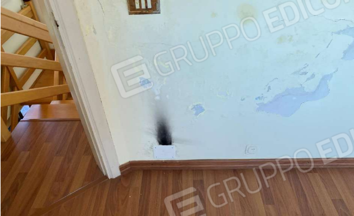
Foto n. 144. Il sistema delle partizioni murarie, richiede interventi di ripristino e messa in sicurezza
