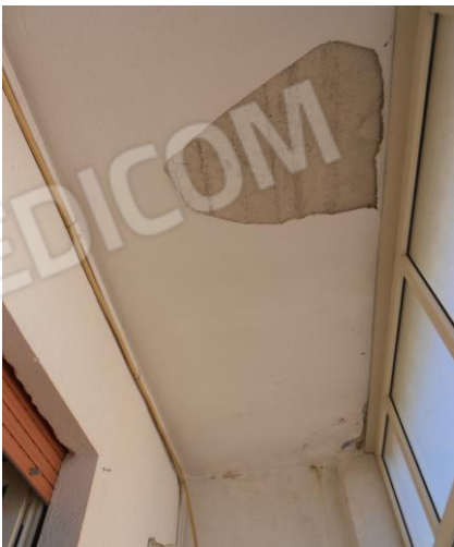
Foto 31 (umidità al soffitto veranda)
