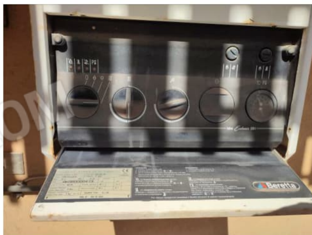
Foto 17: Particolare caldaia autonoma
