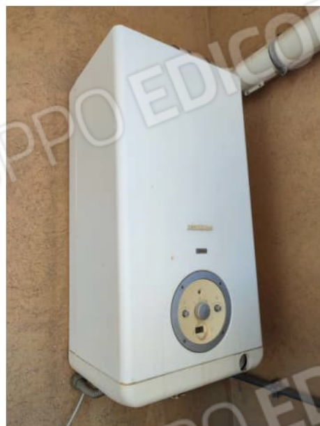
Foto 24: Particolare caldaia autonoma
